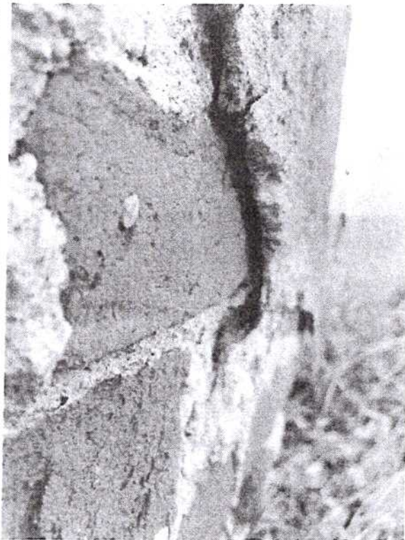
Fot. 6. Zachowane fragmenty tynku odspojone od muru ceglanego.
