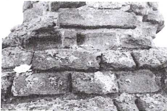
Fot.13. Silne porażenie mikrobiologiczne - mchy, porosty.
