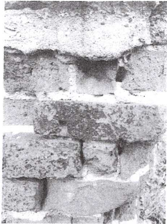
Fot. 8. Cegły silnie zdeintegrowane, wiele z nich straciło swój kształt, osypujące się lico cegły. Widać także ciemne nawarstwienia na cegle.
