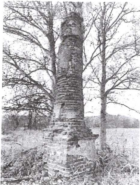
Fot. 1. Obecny stan kolumny, widok od strony południowo-wschodniej.
