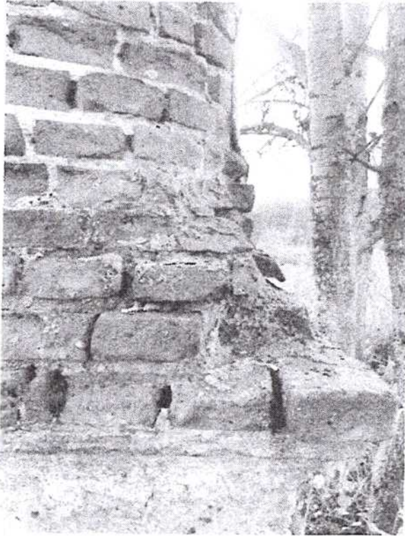
Fot. 11. Zniszczone kształtki stanowiące bazę kolumny, silne porażenie mikrobiologiczne - atak porostów. Wypłukana ze spoin zaprawa.
