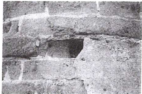
Fot. 14. Widoczna cementowa zacierka, duże ubytki lica cegły, wgłębienia w cegle.
