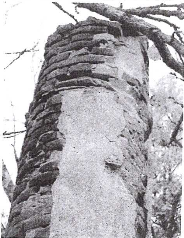
Fot. 5. Od strony zachodniej dobrze zachowane lico cegły, pokryte silnymi nawarstwieniami.
