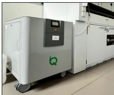
Zdjęcie 47. Generator azotu
