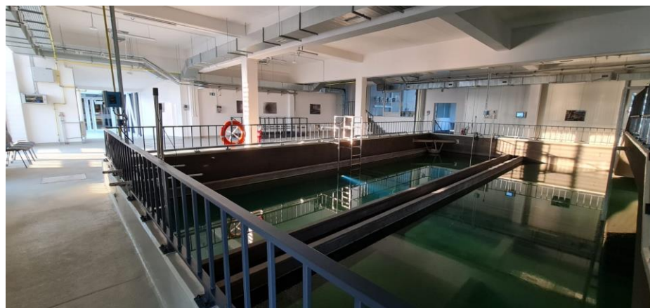
Stacja uzdatniania wody (zbiory IMP w Łodzi).
