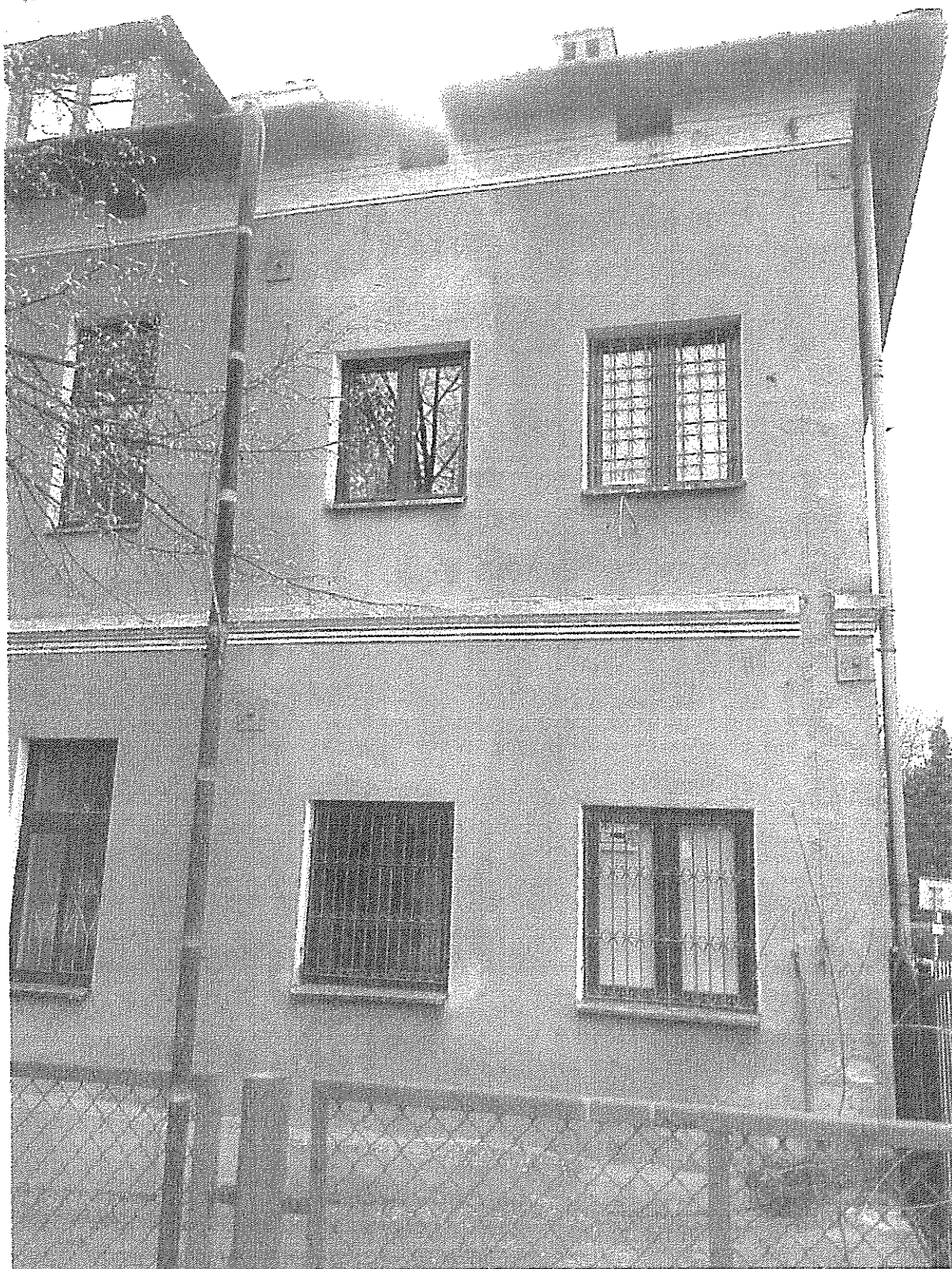
Ryc. 12. Jaworzno ul. Pocztowa 7 elewacja wschodnia fragment I (fot. budynku z dn. 23.04.2016 – S.Czyż)
