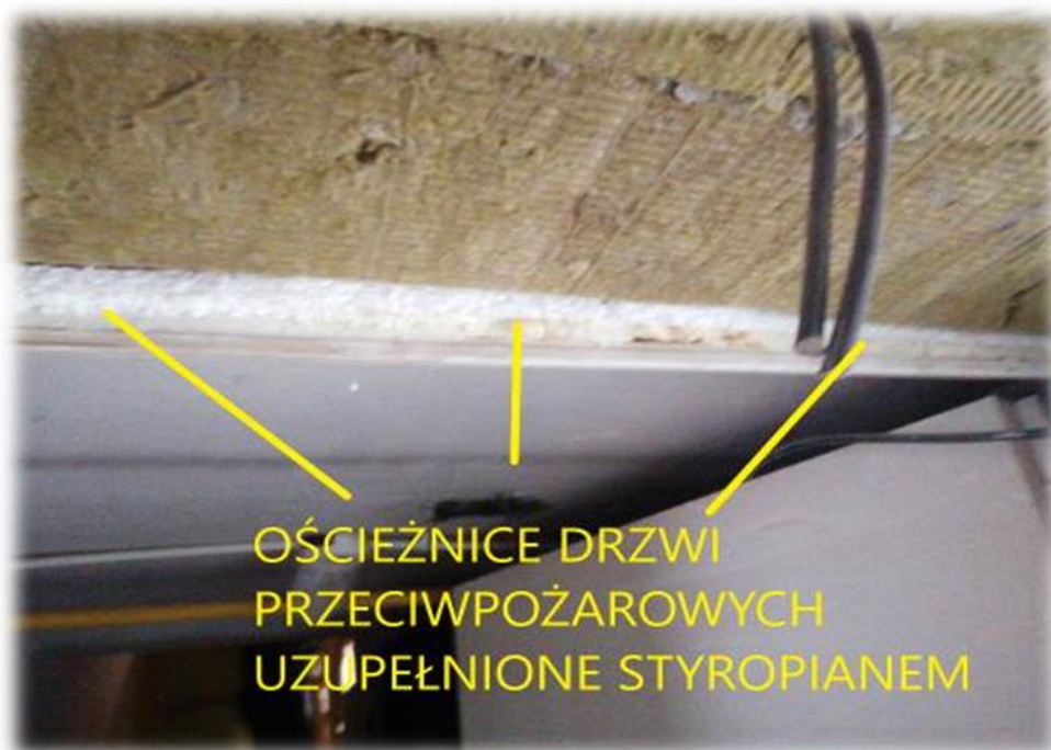
Brak oddzielenia stref pożarowych.
