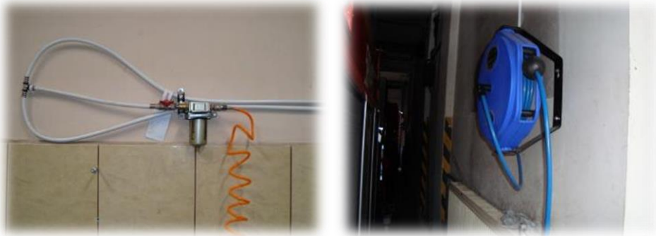
Instalacja pneumatyczna w garażu jednostki.
