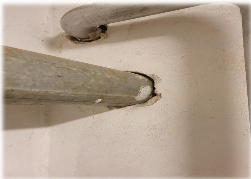
Brak zabezpieczenia przepustów w ścianie oddzielenia przeciwpożarowego.
