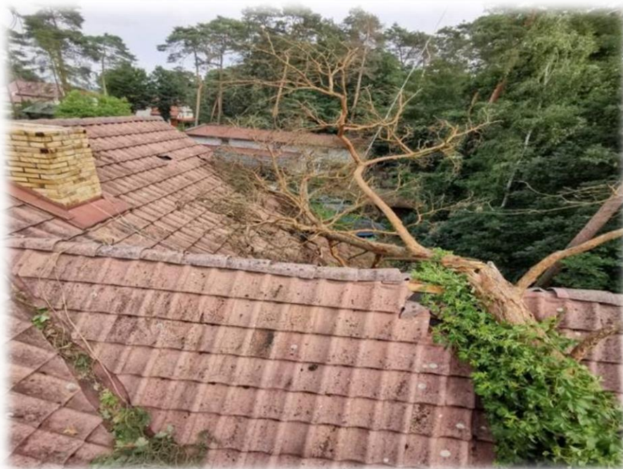
Drzewo powalone na budynek mieszkalny – Głowno ul. Południowa.
