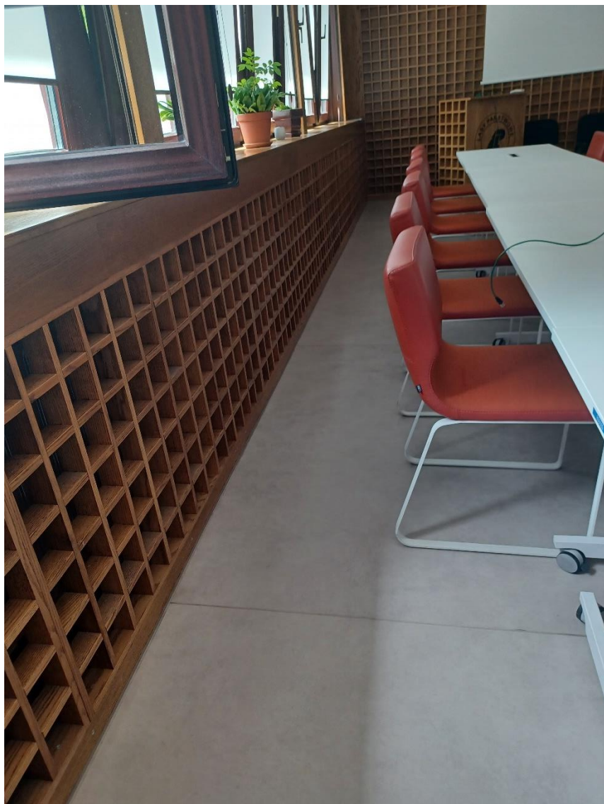
Zdjęcie ukazujące zabudowę grzejników na świetlicy. Przedmiotowa zabudowa składa się z kilku elementów kratownicy powiązanych ze sobą w jedną całość za pomocą wkrętów.
