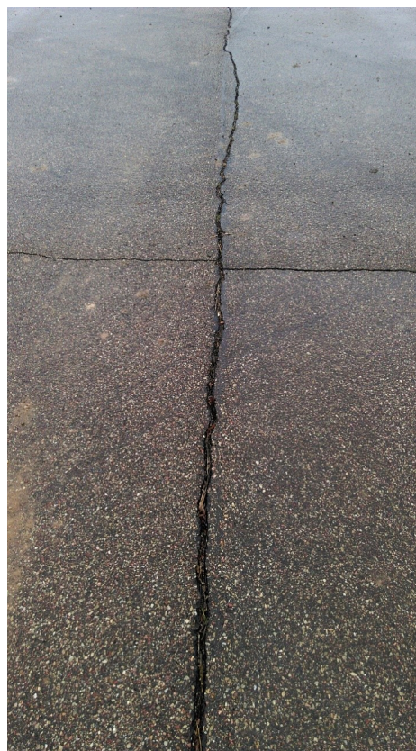
Rys. 15. Pęknięcia wierzchniej warstwy mineralno-asfaltowej obiektu do składowania odpadów (źródło własne).
