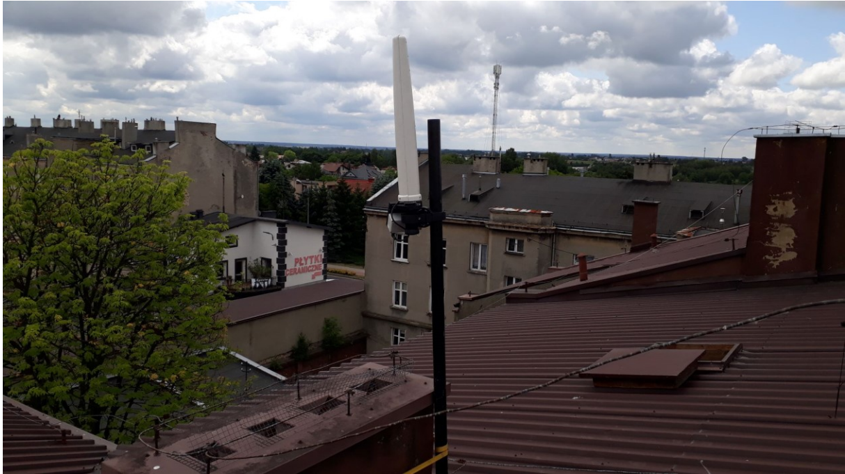
Rys. 3 Miejsce montażu SMS PEM – Szkoła Podstawowa nr 11 w Piotrkowie Trybunalskim – widok na SBTk
