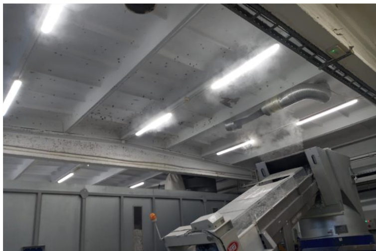
Fot. Przykład złego stanu technicznego sufitu w zakładzie pracy.
