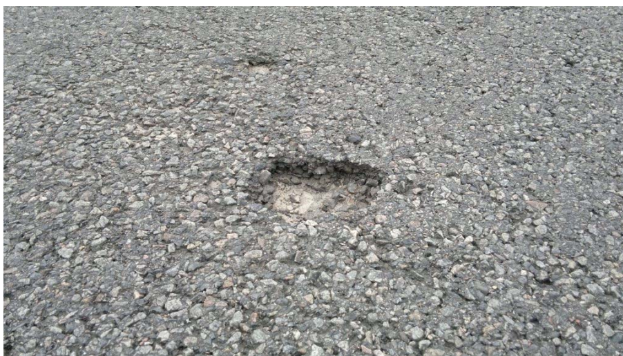
Rysunek 2.27. Ubytek w warstwach bitumicznych
