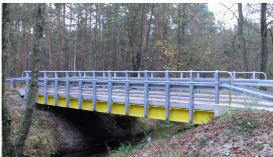
Zdjęcie nr 26. Budowa mostu na rzece Jezierzycy w leśnictwie Orzeszków, rok 2012. (fot. P. Gołąb)
