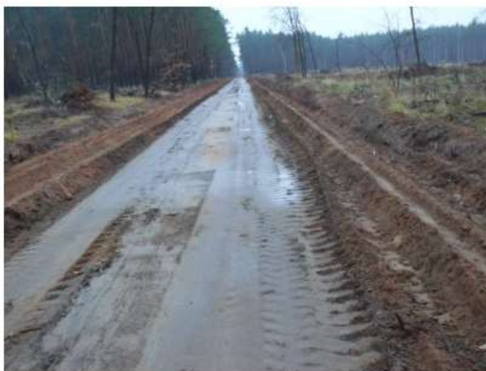
Zdjęcie nr 22. Etap budowy drogi leśnej przeciwpożarowej w leśnictwie Tarchalice, rok 2011. (fot. P. Goląb)
