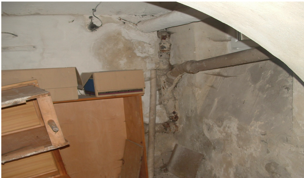
Fot. Nr 15 widoczna korozja i nieszczelności instalacji sanitarnej
