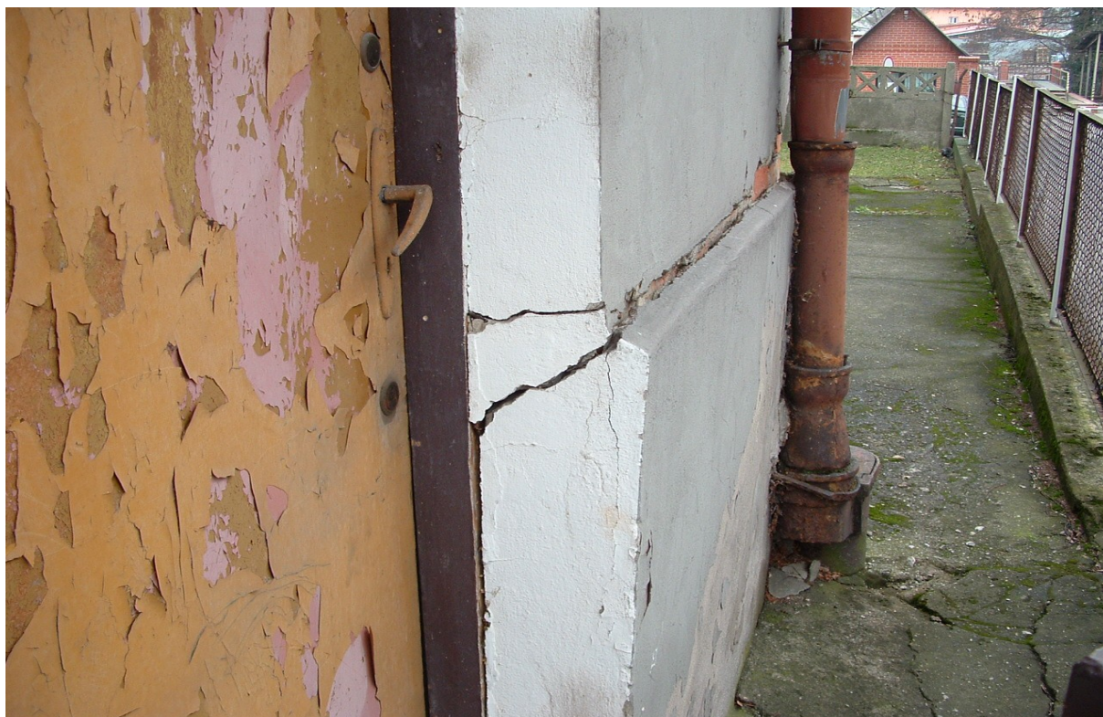
Fot. Nr 2 Widoczne poziome rozwarstwienie ściany spowodowane przemrożeniem
