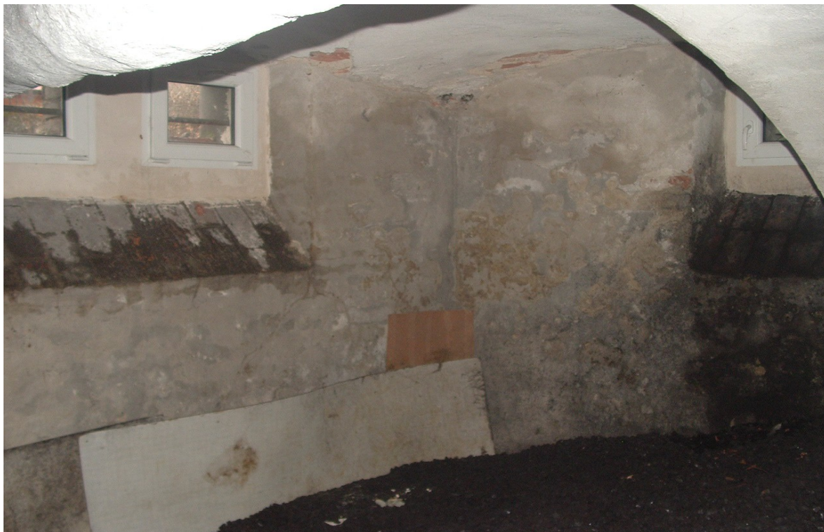
Fot. Nr 12 Widoczne wykwity solne i zawilgocenie na ścianach piwnic
