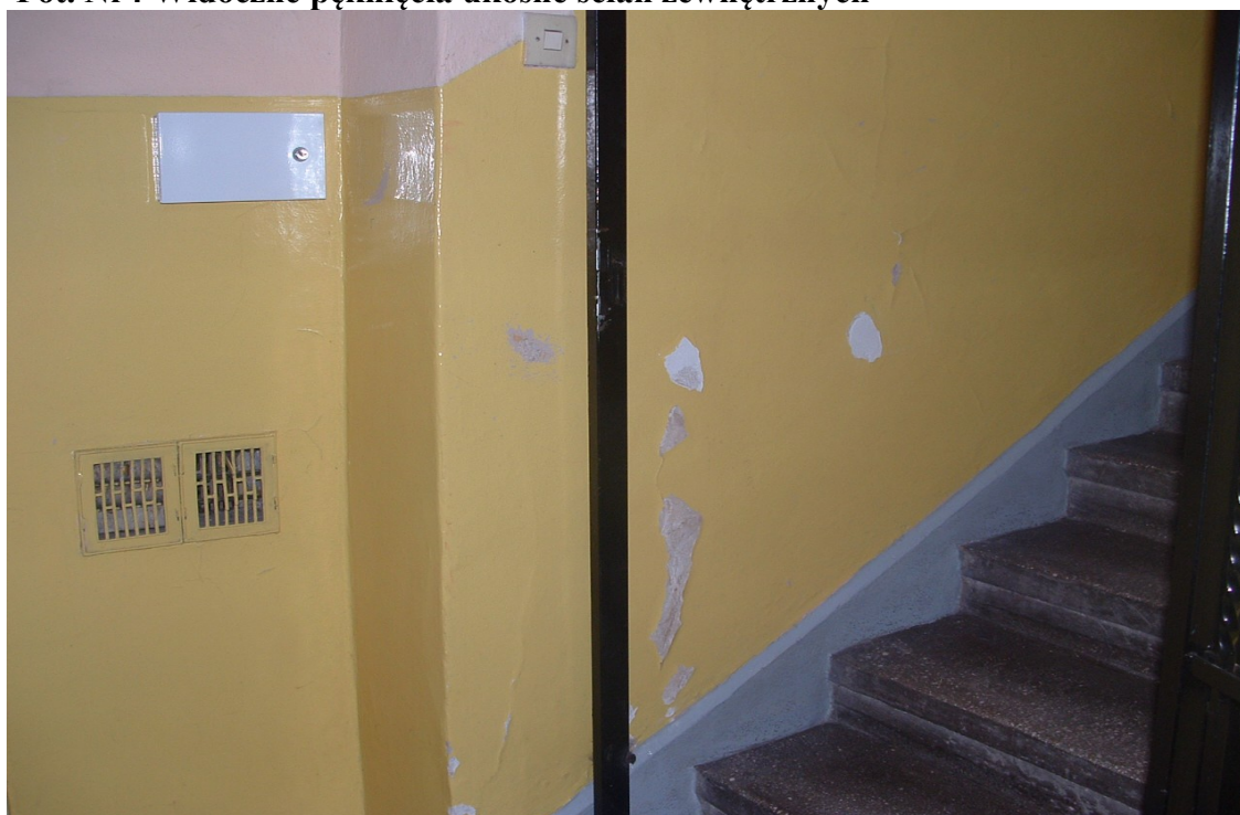
Fot. Nr 5 widoczne uszkodzenia tynków wewnętrznych
