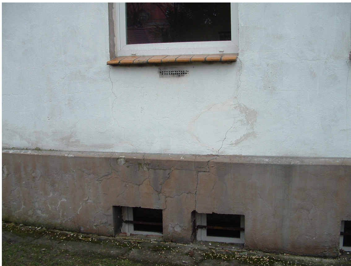
Fot. Nr4 Widoczne pęknięcia ukośne ścian zewnętrznych
