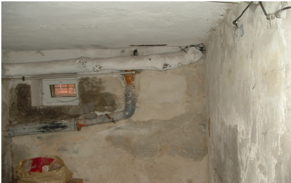
Fot. Nr 13 widoczne uszkodzenia instalacji sanitarnej
