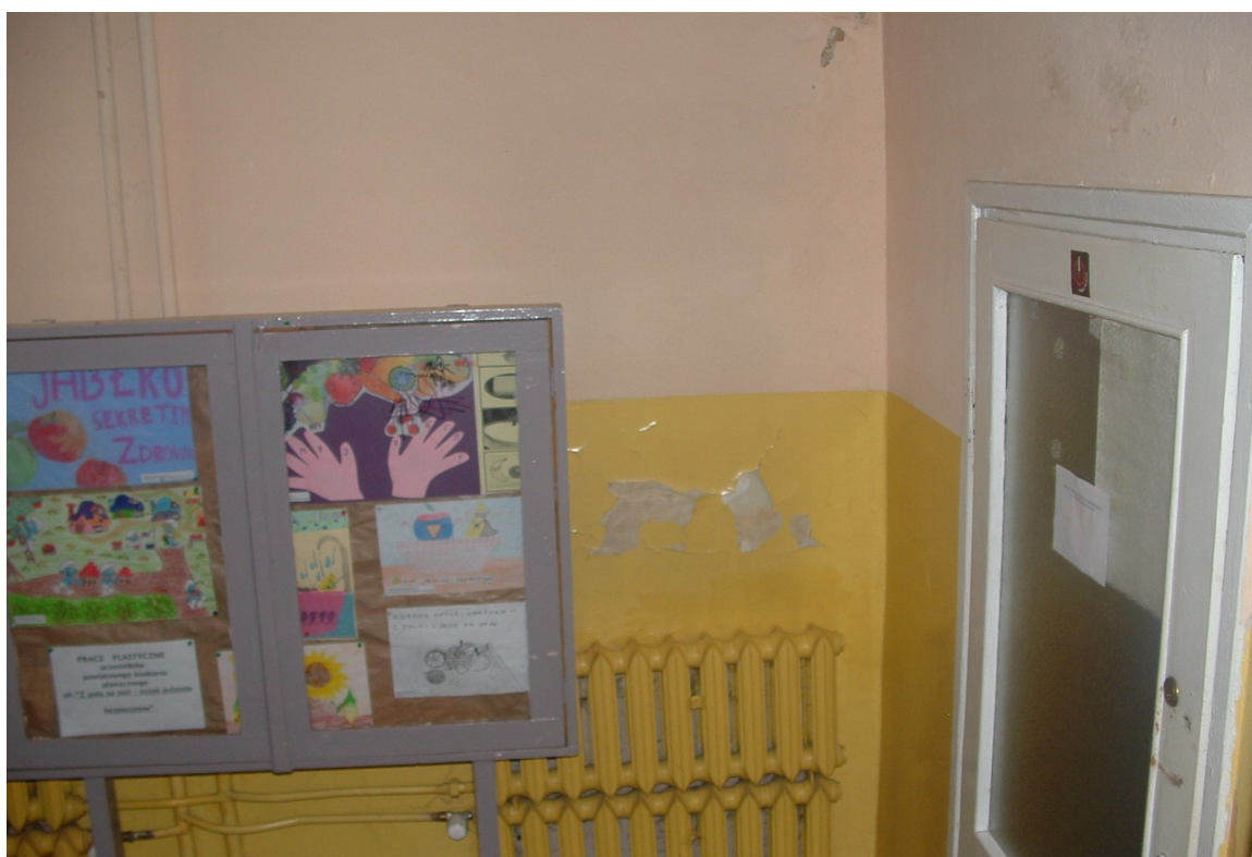
Fot. Nr 7 widoczne uszkodzenia tynków wewnętrznych
