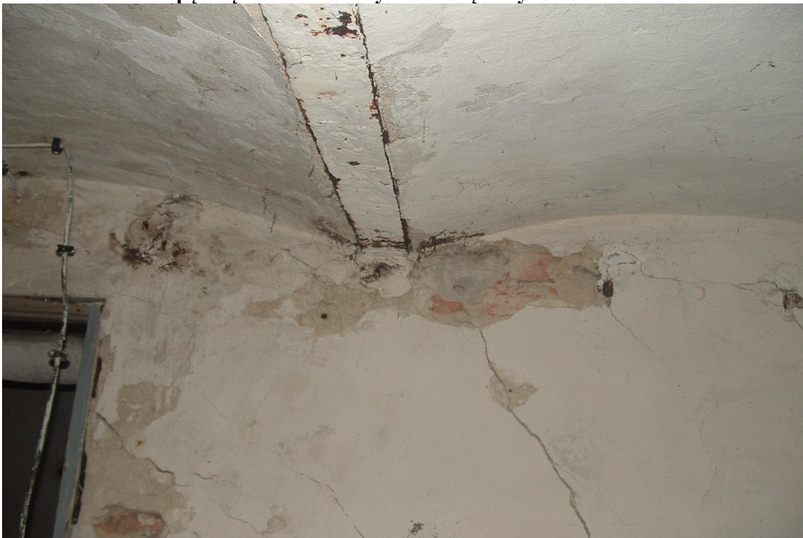
Fot. Nr 9 Widoczna korozja belek stropowych i pęknięcia ścian w miejscu podparcia
