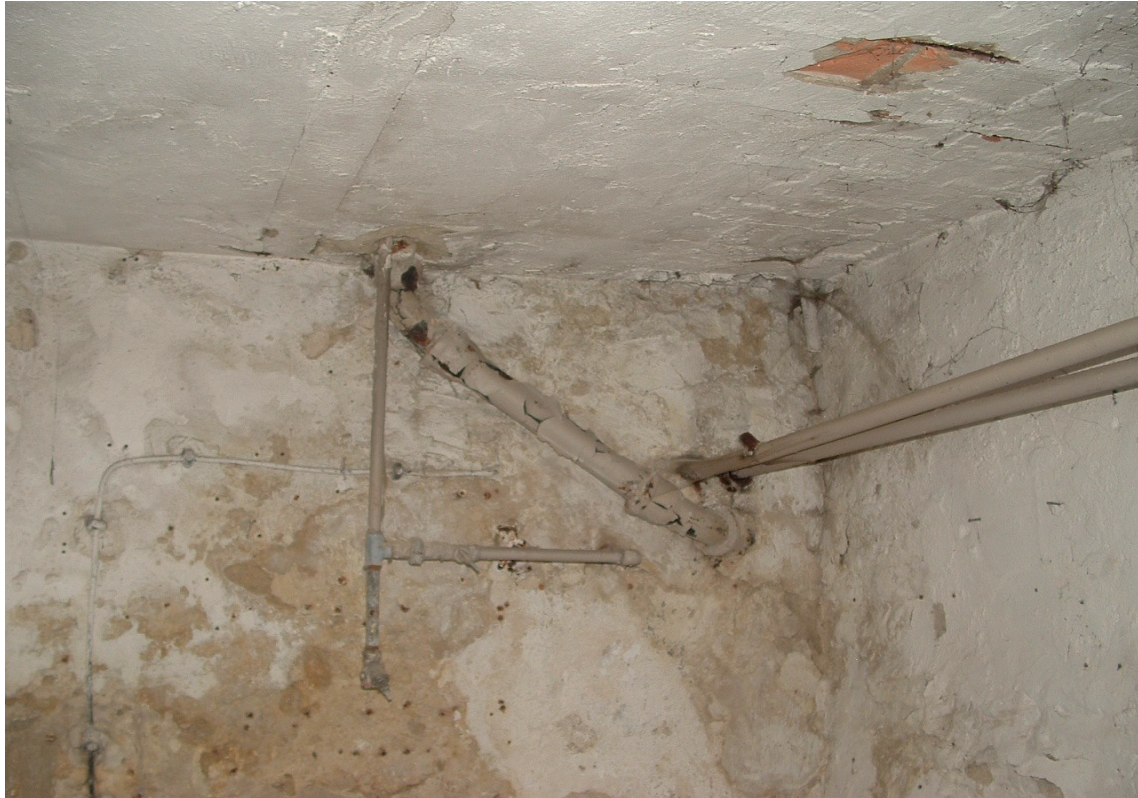
Fot. Nr 14 widoczne uszkodzenia instalacji sanitarnej
