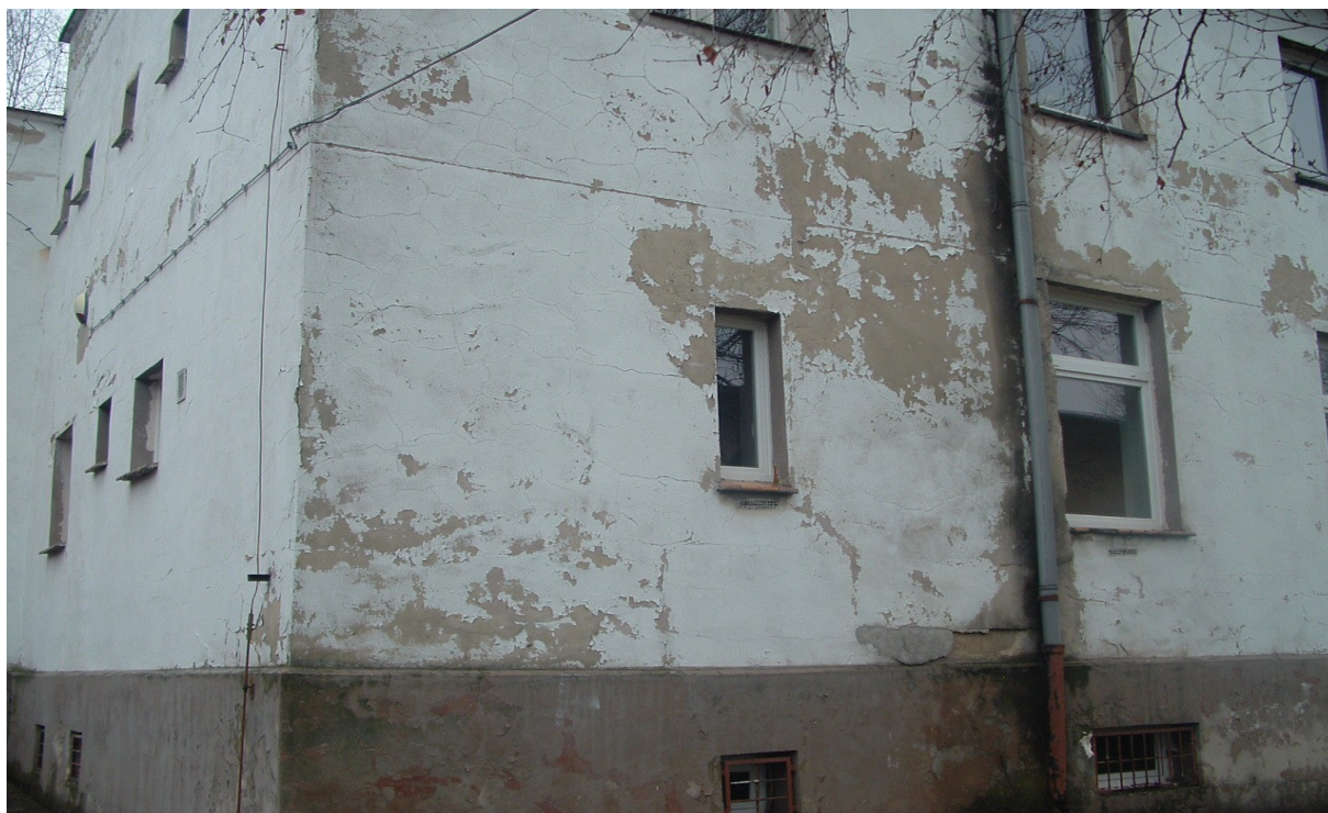
Fot. Nr1 Widoczne uszkodzenia elewacji i rur spustowych.
