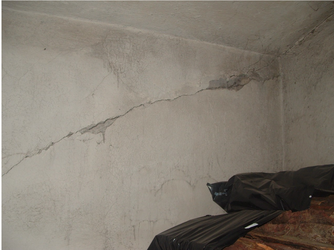
Fot. Nr 8 Widoczne pęknięcia ścian nośnych wewnętrznych
