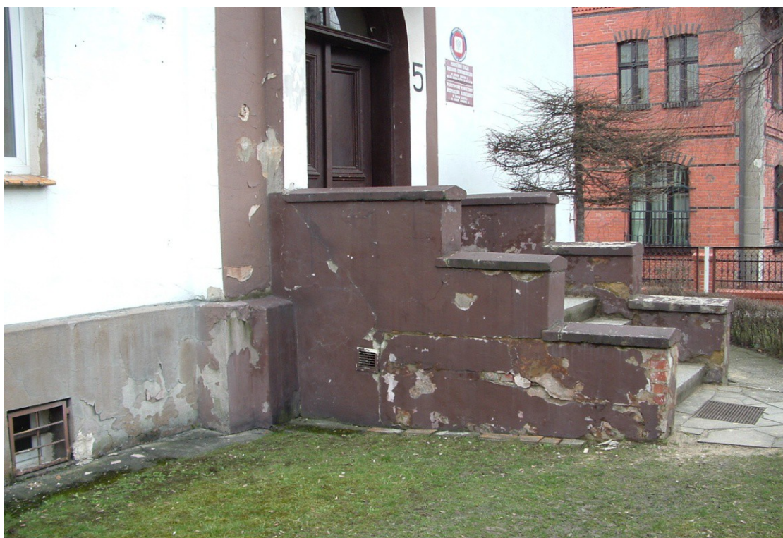
Fot. Nr 3 Stan techniczny wejścia do budynku z widocznymi barierami architektonicznymi.
