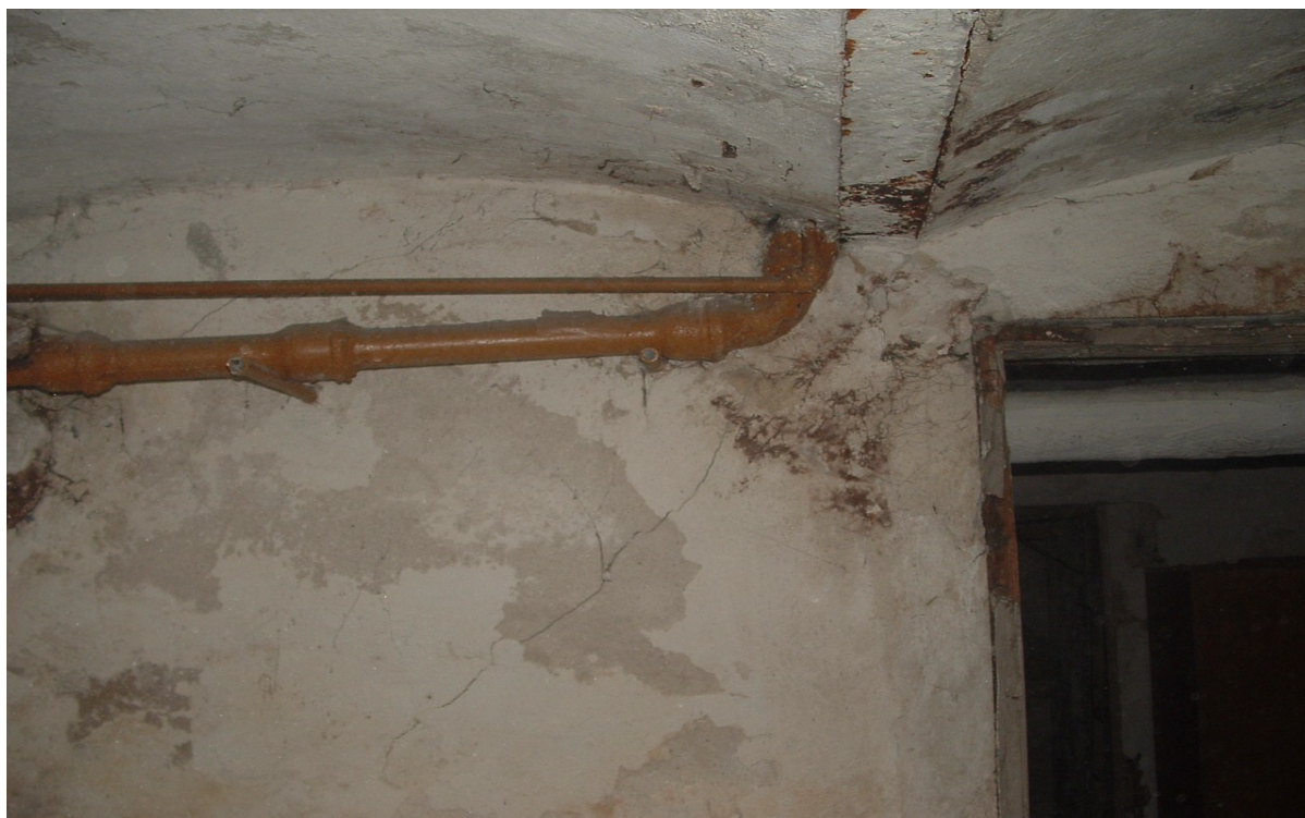
Fot. Nr 10 Widoczna korozja belek stropowych i pęknięcia ścian w miejscu podparcia
