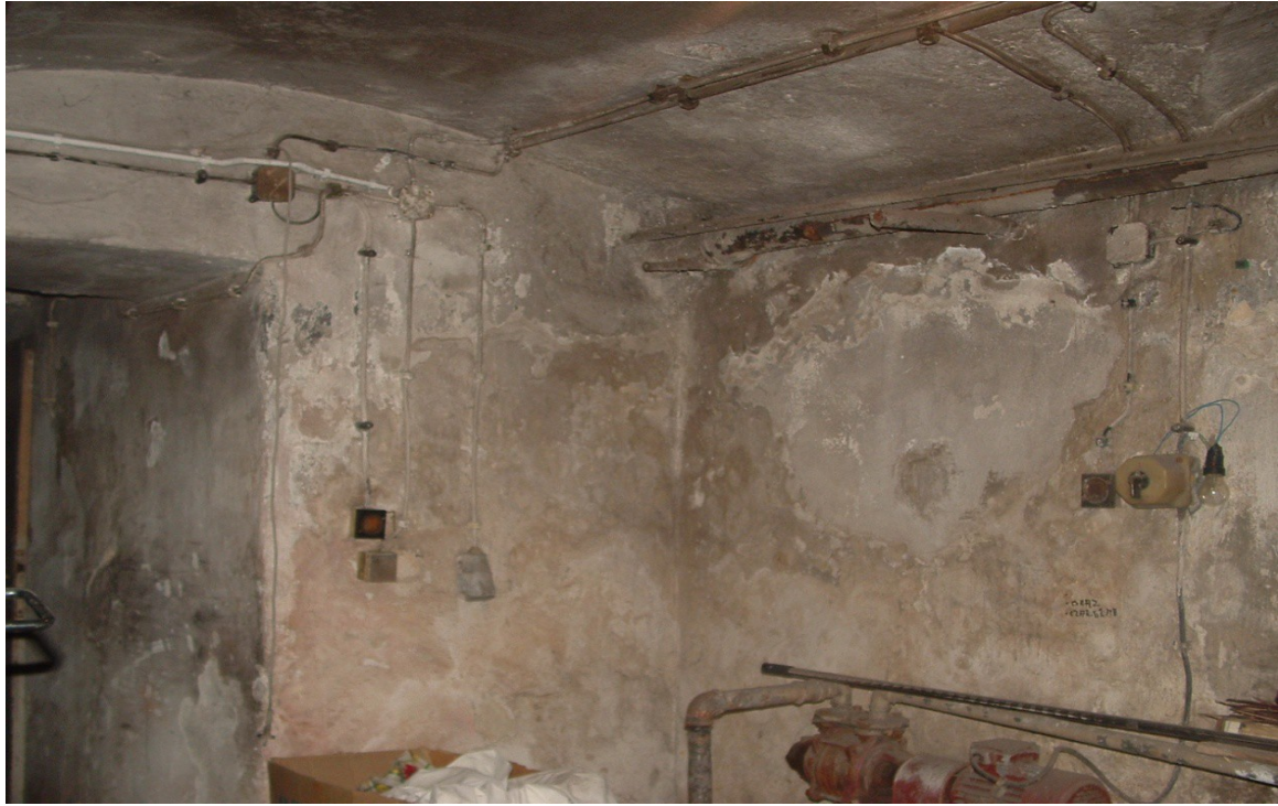
Fot. Nr 18 stan instalacji elektrycznej kotłowni
