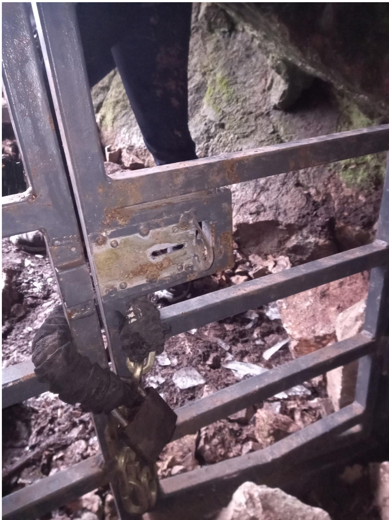
Zdj. 2 Obecny stan furtki z oderwaną zasuwą
