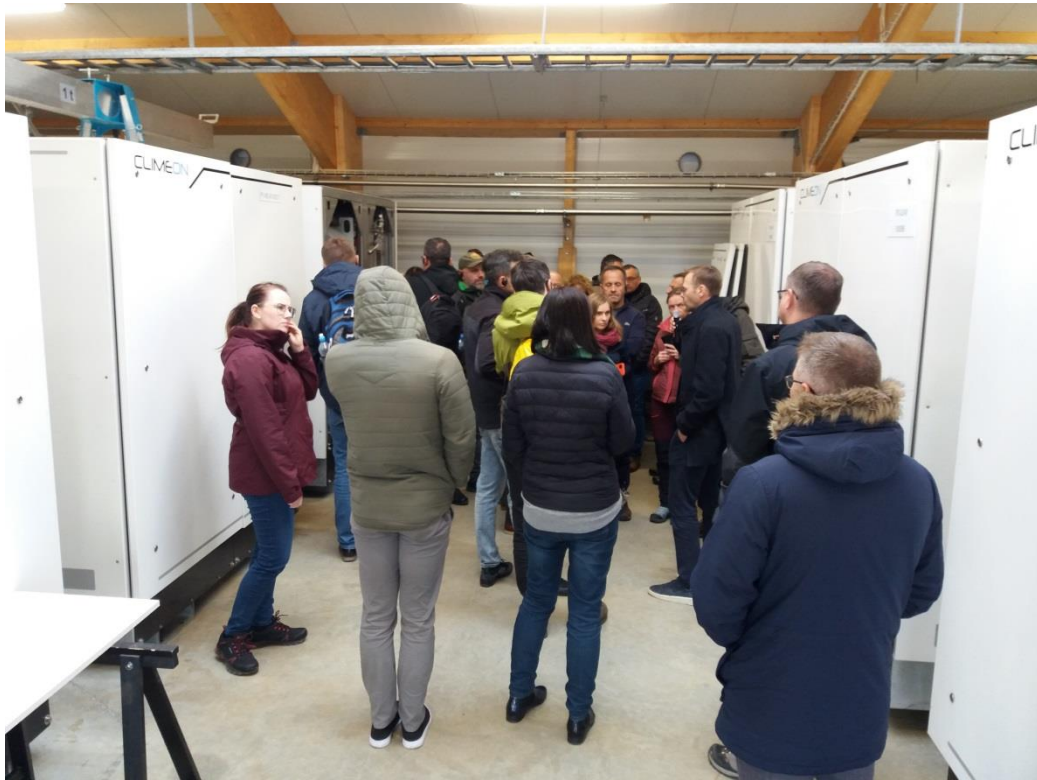
We wnętrzu kontenera z głównymi elementami instalacji kogeneracyjnej (ORC) we Fludir (fot. B. Kępińska)
