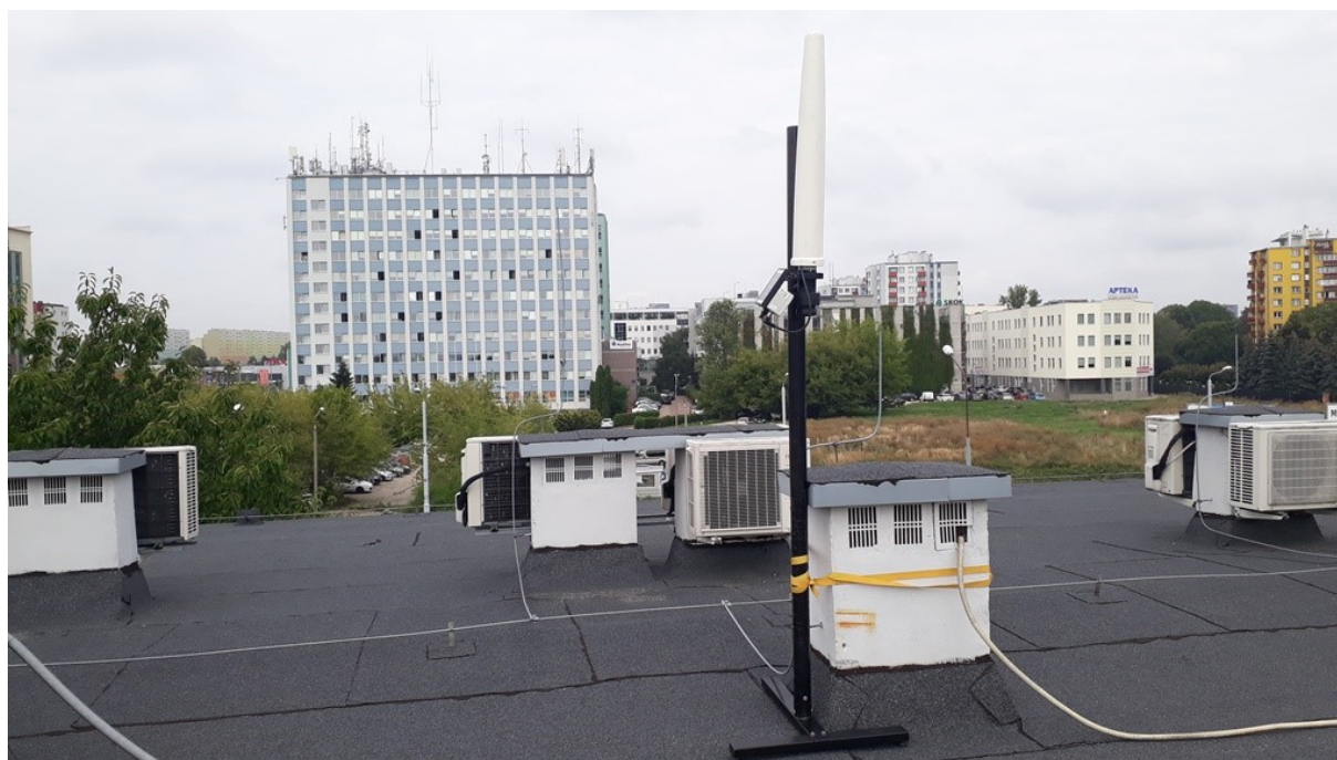
Rys. 3 Miejsce montażu SMS PEM – MOSiR „Bystrzyca” w Lublinie – widok na SBTK
