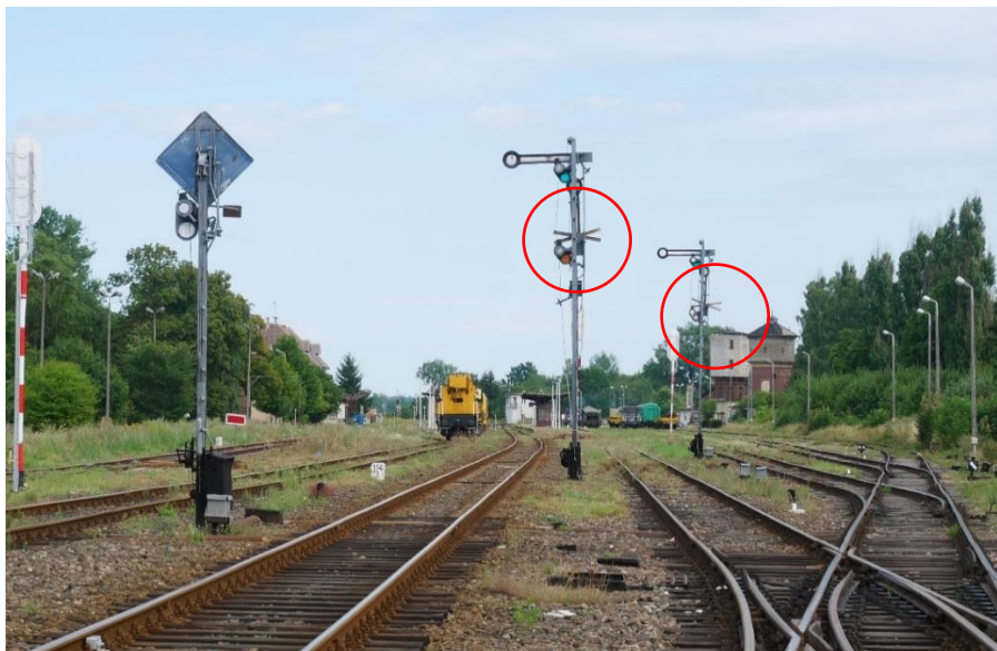
Zdjęcie 3 - Niewłaściwe umieszczenie i wykonanie wskaźników W31 stacja Złocieniec
