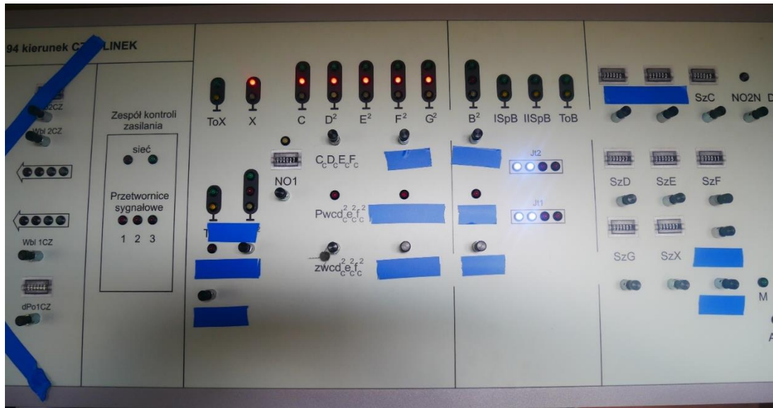
Zdjęcie 6 - „Skrzynka z przyciskami i powtarzaczami (pulpit)” nastawnia „Zł”
