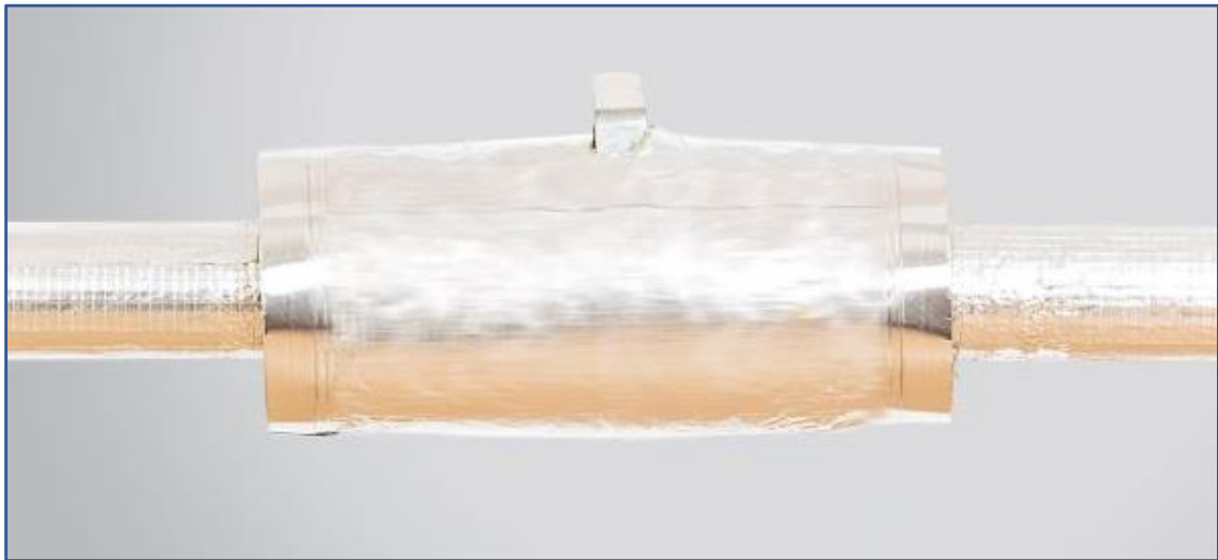
fot. 4 centrum izolacji: prawidłowo zaizolowany zawór
