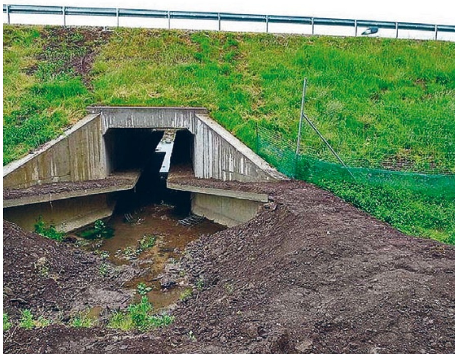
Ryc. 6. Przejście dla płazów i innych małych zwierząt po znielowaniu błędów konstrukcyjnych (fot. K. Okrański)
