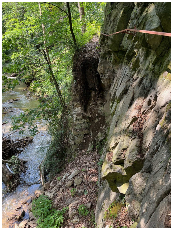
fot. nr 1 - widok ogólny miejsca w którym doszło do zawalenia.
