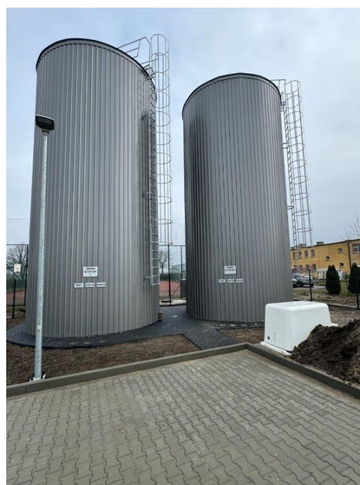
Zdjęcie 2. Zbiorniki zewnętrzne na Stacji Uzdatniania Wody w Gieczu
