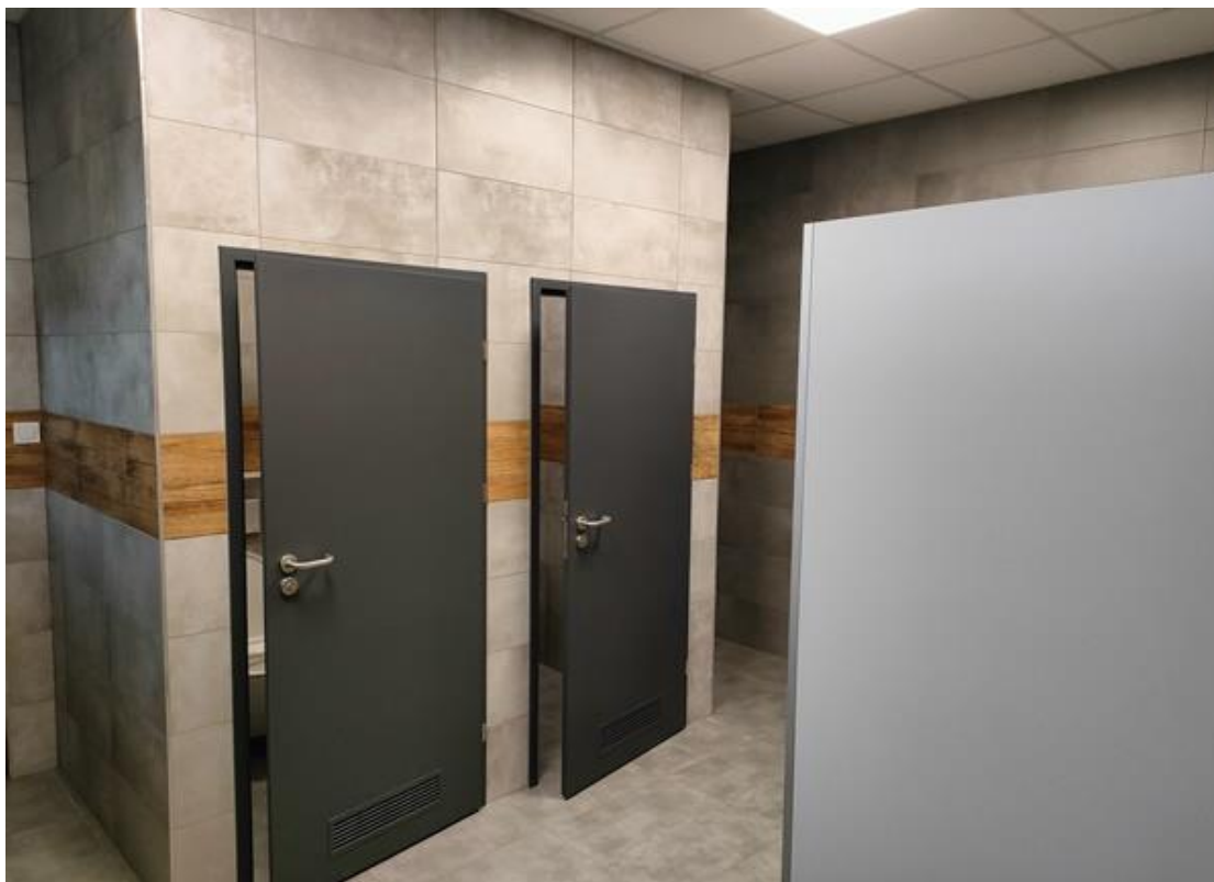
Zdjęcie nr 9. Pomieszczenia higieniczno-sanitarne przy sali gimnastycznej Zespołu Szkoły Podstawowej i Przedszkoli w Kopanicy
