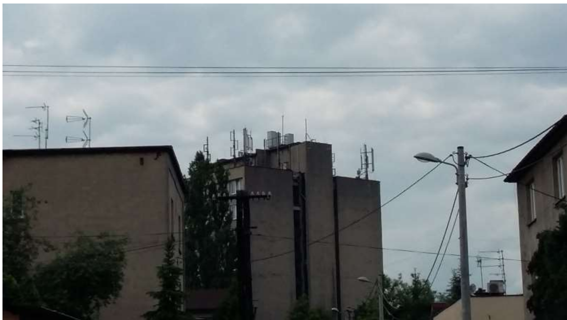
Fot. 3. Fragment instalacji radiokomunikacyjnej na dachu budynku przy ul. Medyków
