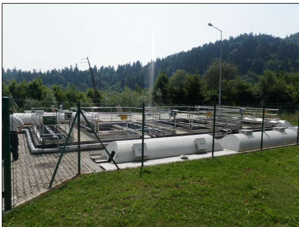
Ryc. 6. Ogólny widok na urządzenia gminnej oczyszczalni ścieków w Wołkowyji administrowanej przez Gminny Zakład Komunalny Sp. z o. o. w Polańczyku, Wołkowyja, 2015-07-09 [źródło: [7]]
