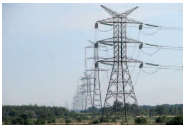
Fot. 1. Elektroenergetyczna linia przesyłowa 400 kV
