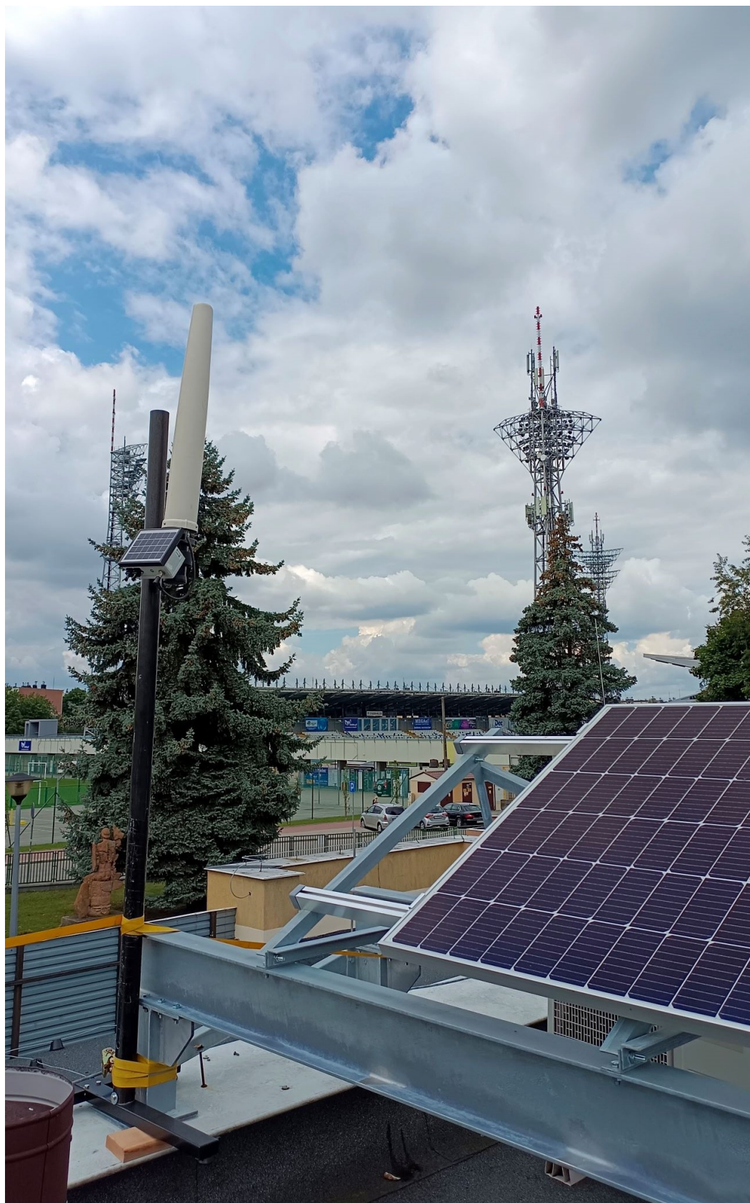
Rys. 3 Miejsce montażu SMS PEM – Szkoła Podstawowa nr 6 w Mielcu – widok na SBTK
