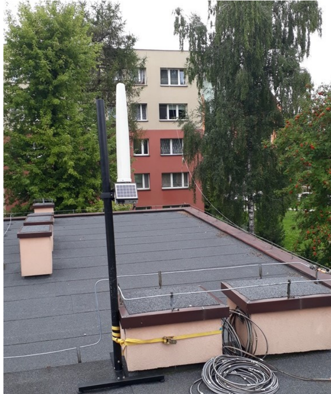
Rys. 3 Miejsce montażu SMS PEM – Przedszkole nr 14 w Tarnowie – widok na SBTk-1
