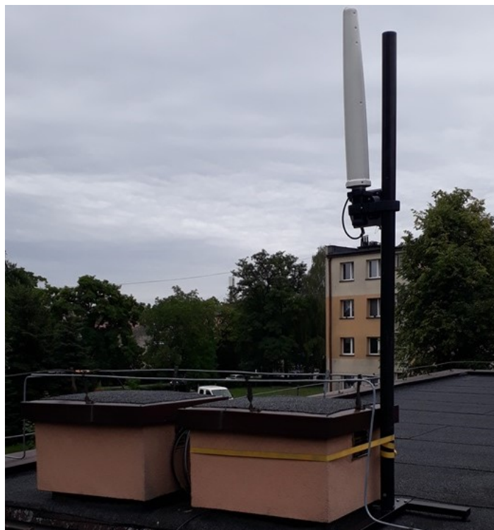
Rys. 4 Miejsce montażu SMS PEM – Przedszkole nr 14 w Tarnowie – widok na SBTk-2
