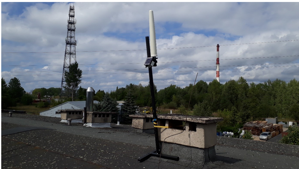
Rys. 3 Miejsce montażu SMS PEM – WIOŚ Delegatura w Suwałkach – widok na SBTk
