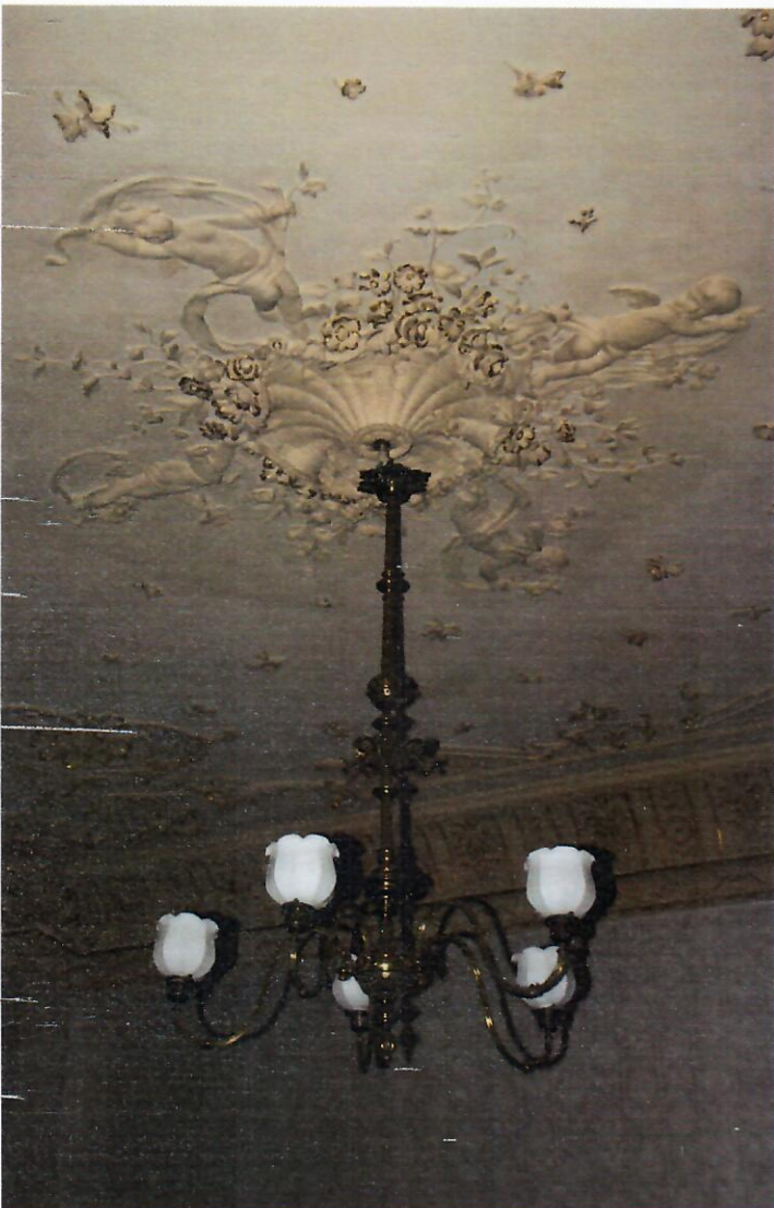
Fot. nr 17, 18 Instytut Ekspertyz Sądowych, naroże ulic Westerplatte 9 i Marii Skłodowskiej Curie 1 w Krakowie. Stan przed konserwacją. Wnętrze Gabinetu Dyrektora Naczelnego. Fotografia nr 17 przedstawia fragment zabrudzonej i zakurzonej tapety. Fotografia nr 18 przedstawia mosiężny, współczesny nieco zakurzony żyrandol ze szklanymi kielichami.
