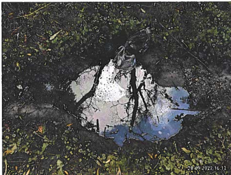
Zdjęcie 17. Wylot do kanału deszczowego znajdujący się na działce, z widocznym wypływaniem substancji ropopochodnych.
