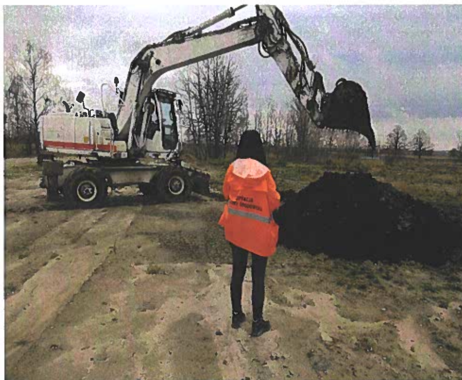
Zdjęcie 35. Dobrów, gm. Tuczępy – przetwarzanie odpadów w postaci komunalnych osadów ściekowych, skratek poprzez umieszczenie ich w gruncie, bez wymaganego zezwolenia
