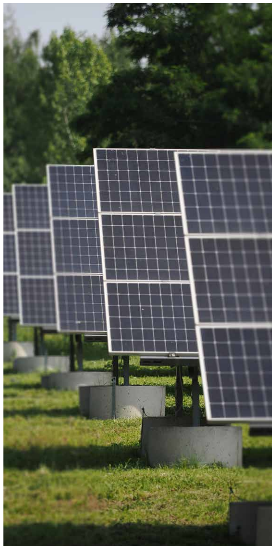
Fot. Błażej Boryń, Farma fotowoltaiczna
