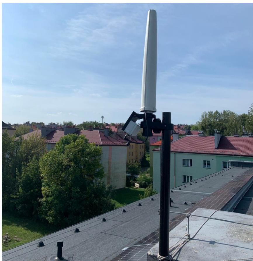
Rys. 2 Miejsce montażu SMS PEM – Szkoła Podstawowa nr 20 – widok na SBTK
