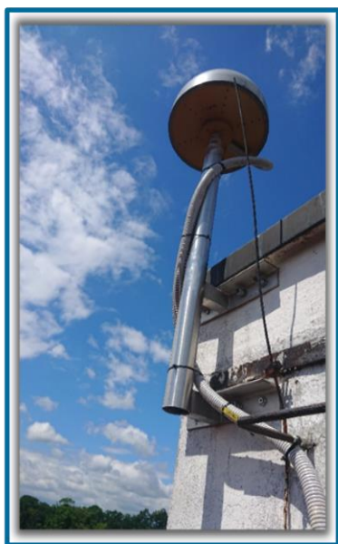
Zdjęcia zainstalowanej stacji w Oleśnicy
