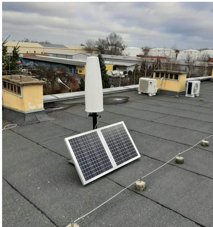
Rys. 3 Miejsce montażu SELMS PEM – IŁ-PIB we Wrocławiu
