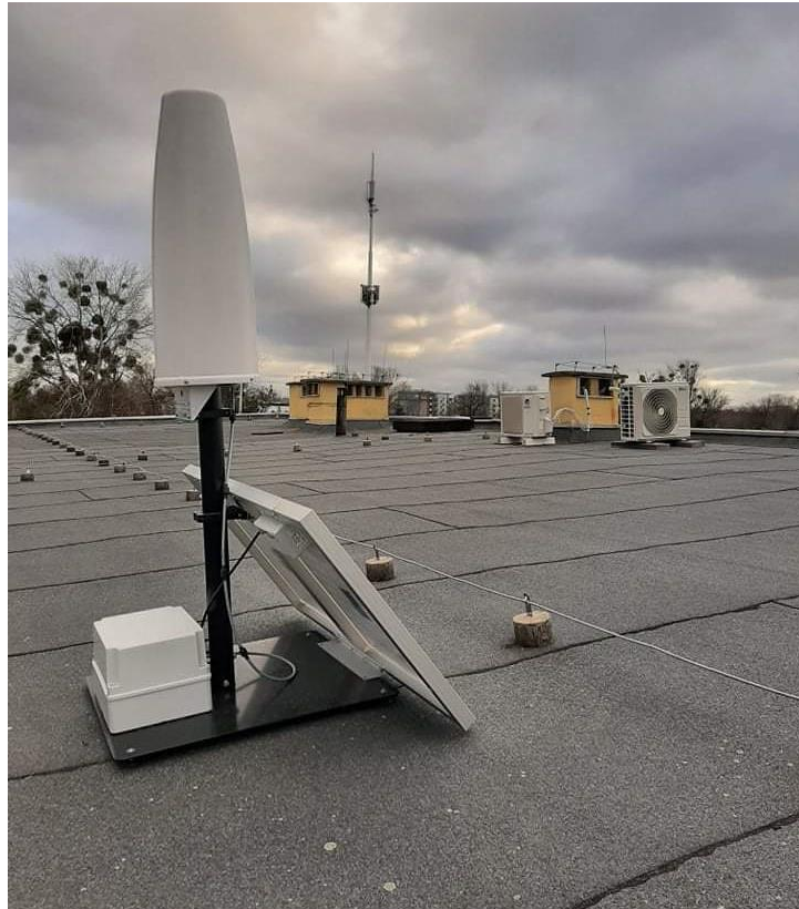
Rys. 2 Miejsce montażu SELMS PEM – IŁ-PIB we Wrocławiu – widok na najbliższe anteny SBTK
