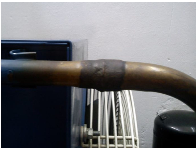
Rys. 10.3. Przykład połączenia lutowanego (połączenie skraplacza z resztą instalacji za pomocą luty twardego).
