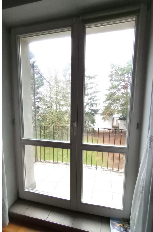
Fot. 1 Budynek mieszkalny – drzwi balkonowe
