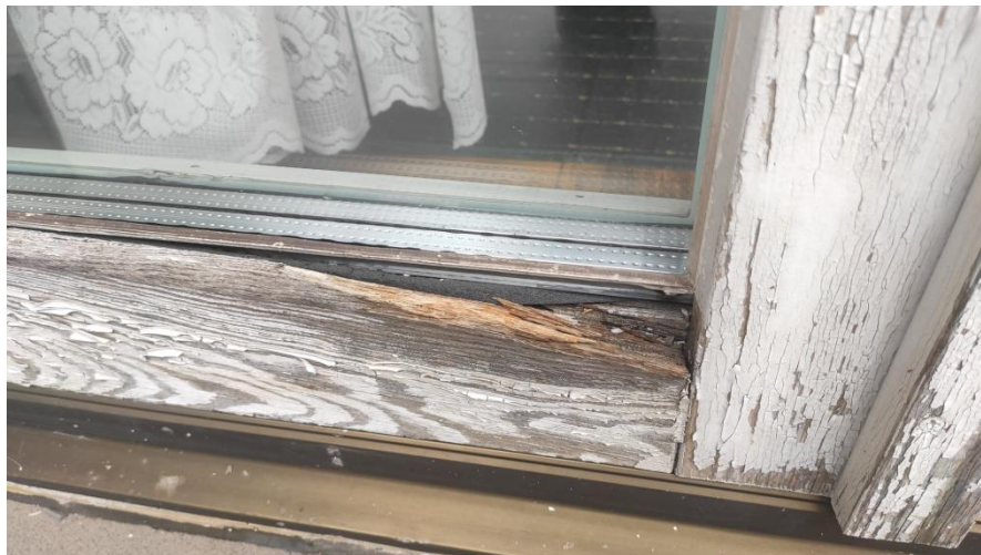
Fot. 1 Budynek mieszkalny – drzwi balkonowe
