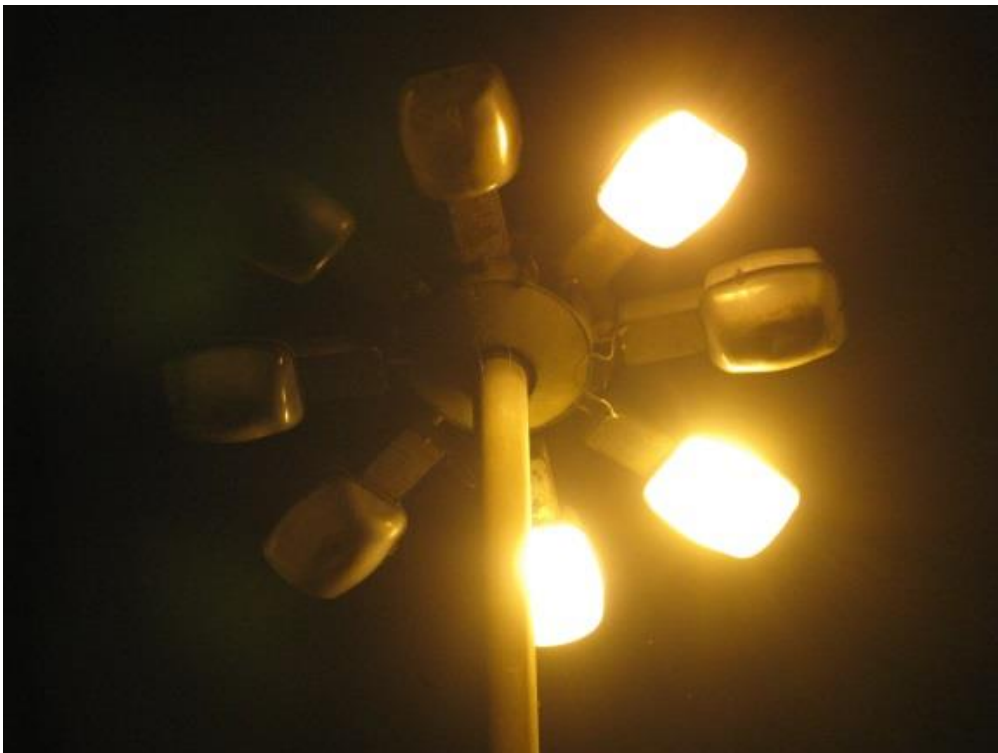
Rys. 10.68 Uszkodzone źródła światła w oprawach oświetleniowych – przykład 2
