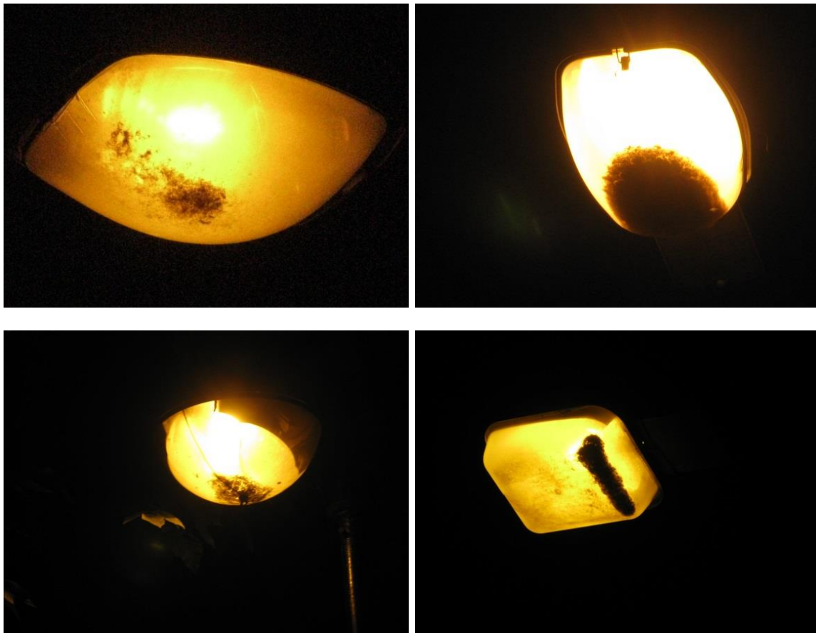
Rys. 10.72 Brudne klosze opraw oświetleniowych
