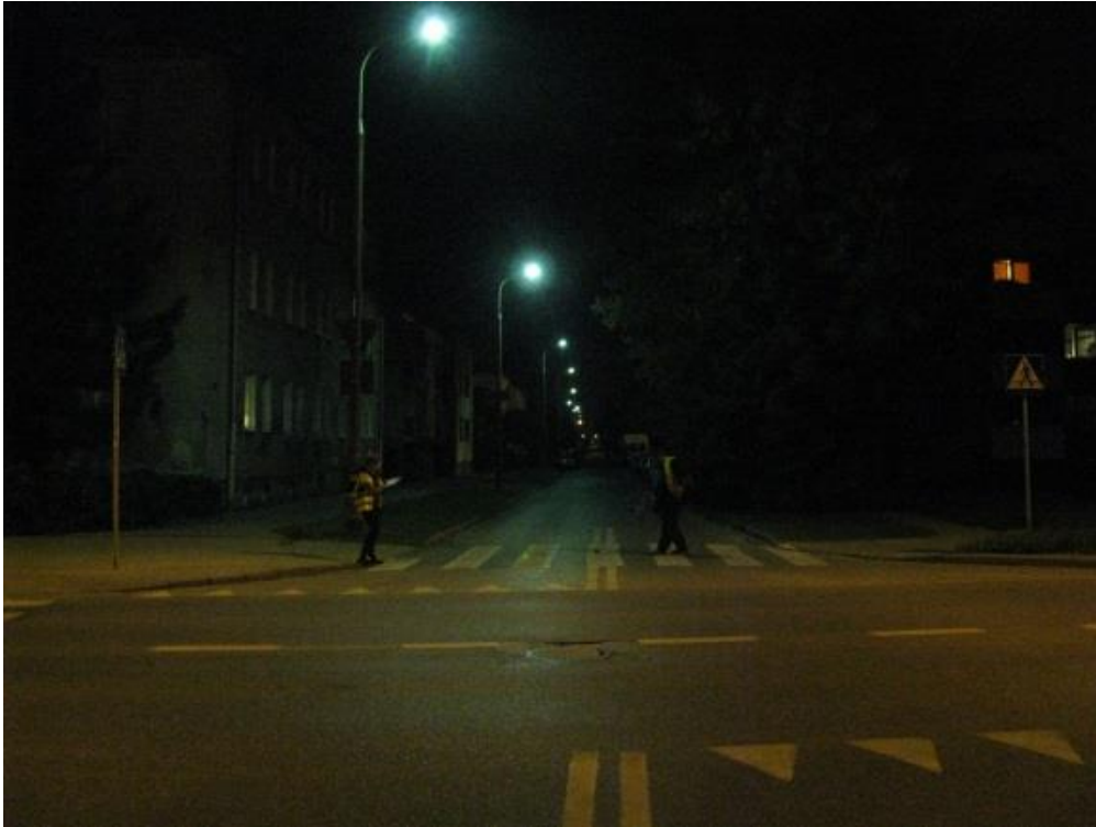
Rys. 10.53 Nieefektywne instalacje oświetlenia ulicznego -przykład 5
