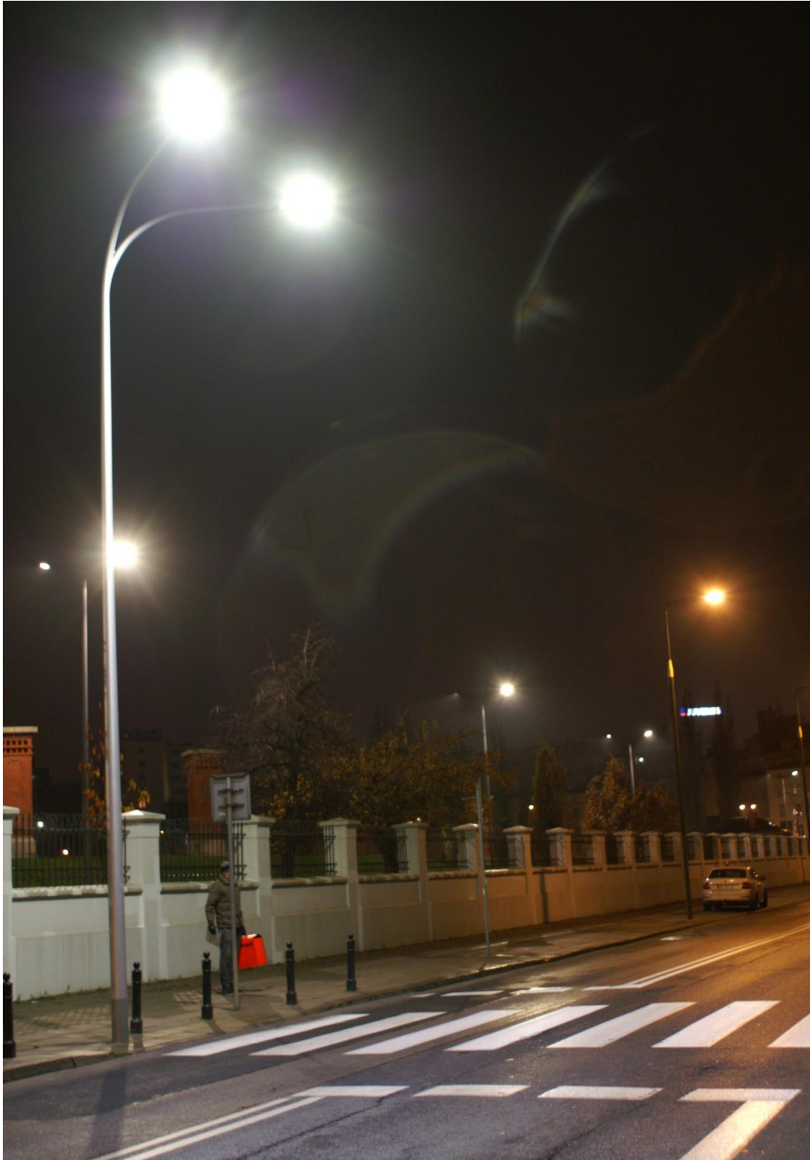
Rys. 9.1 Widok przejścia dla pieszych oraz dodatkowego oświetlenia
