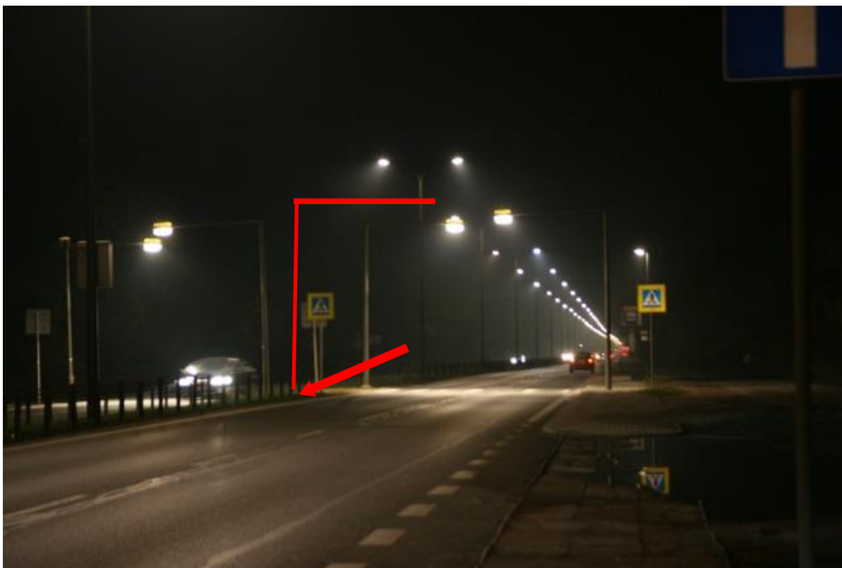
Rys. 10.40 Błędny dobór rozsyłów opraw oświetleniowych do kierunków ruchu
