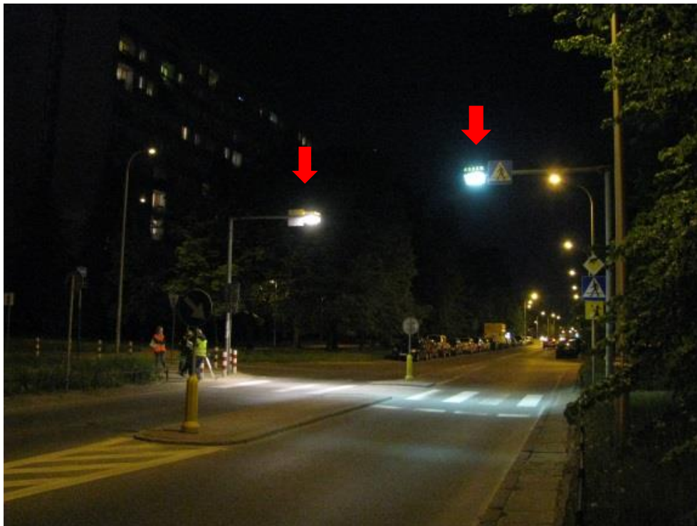
Rys. 10.44 Nieujednolicona barwa źródeł światła w sąsiadujących oprawach oświetleniowych – przykład 1
