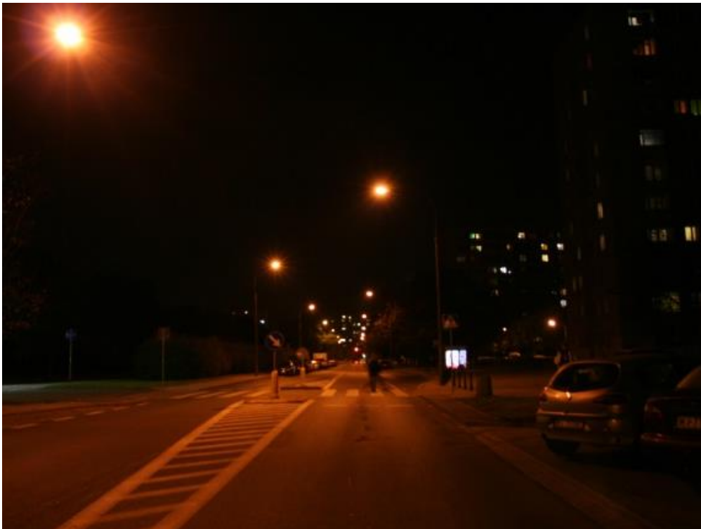
Rys. 10.54 Nieefektywne instalacje oświetlenia ulicznego – przykład 6
