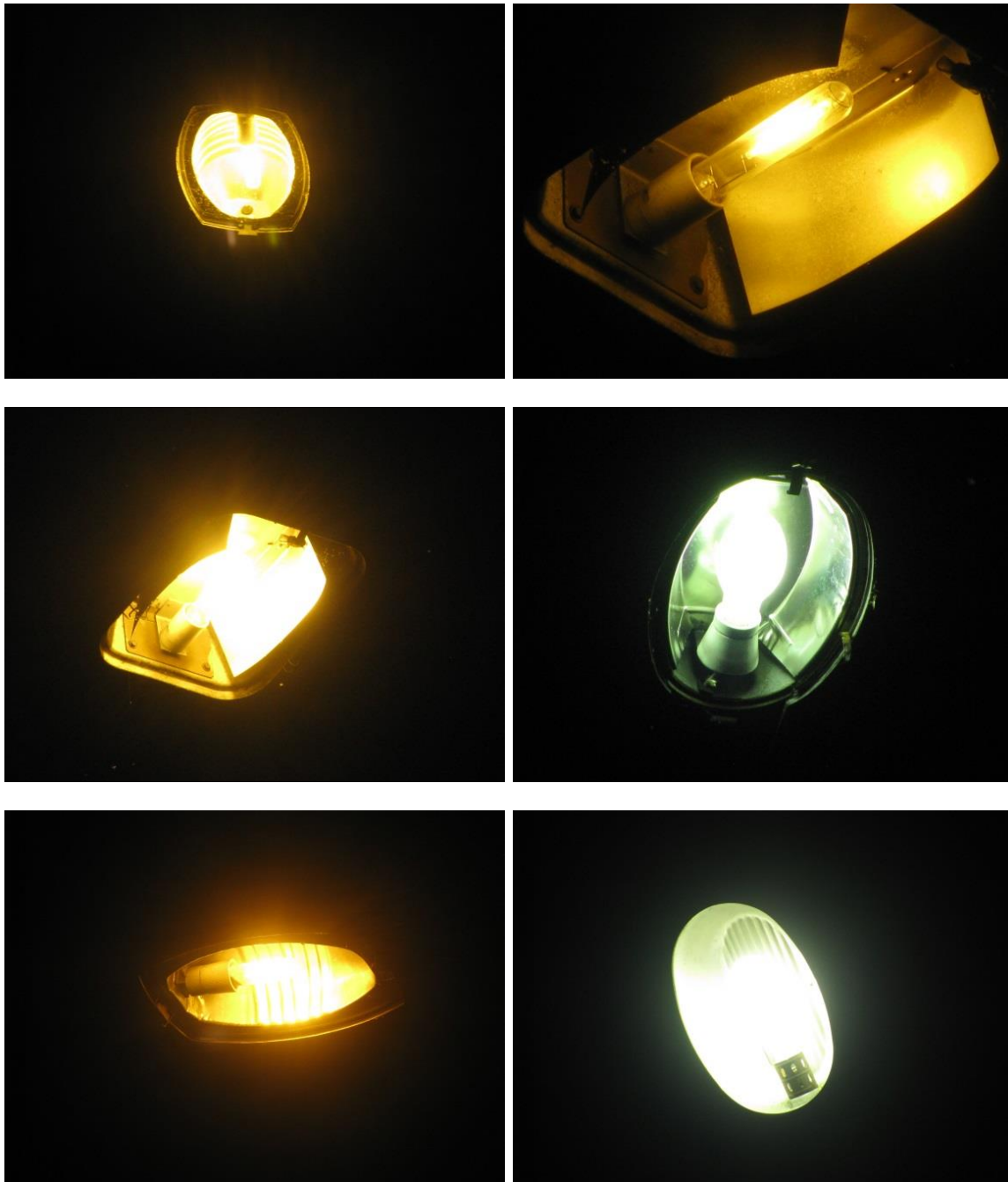
Rys. 10.71 Brak kloszy w oprawach oświetleniowych
