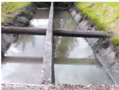
Zanieczyszczony odstożnik wody deszczowej
