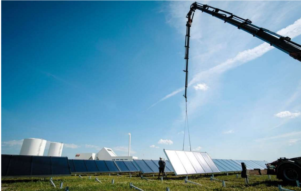
Rys. 1: Instalacja solarna na potrzeby sieci ciepłowniczej w Aabybro, Dania
