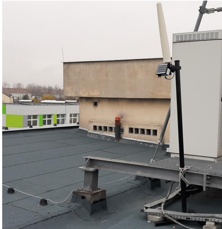
Rys. 2 Miejsce montażu SMS PEM – dach Publicznej Szkoły Podstawowej nr 14 im. Adama Mickiewicza w Opolu
