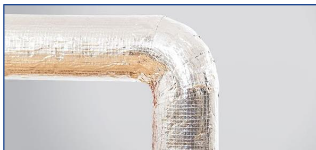
fot. 4 centrum izolacji: poprawnie zaizolowane kolanko
