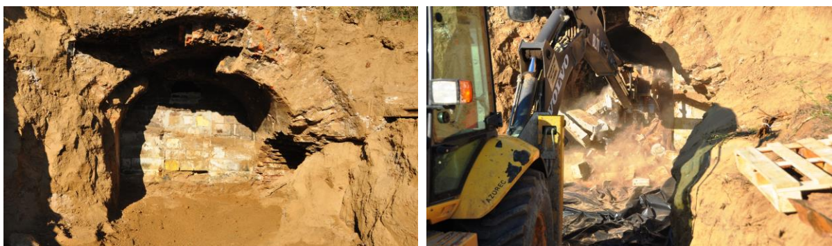
Fot. 7, 8. Odkryte wejście do mogilnika, widoczny ( po stronie lewej ) murek zabezpieczający oraz jego rozbiórka
