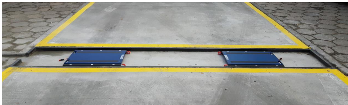
Rys. 4. Stalowy kątownik zabezpieczający krawędź wnęki wagowej
