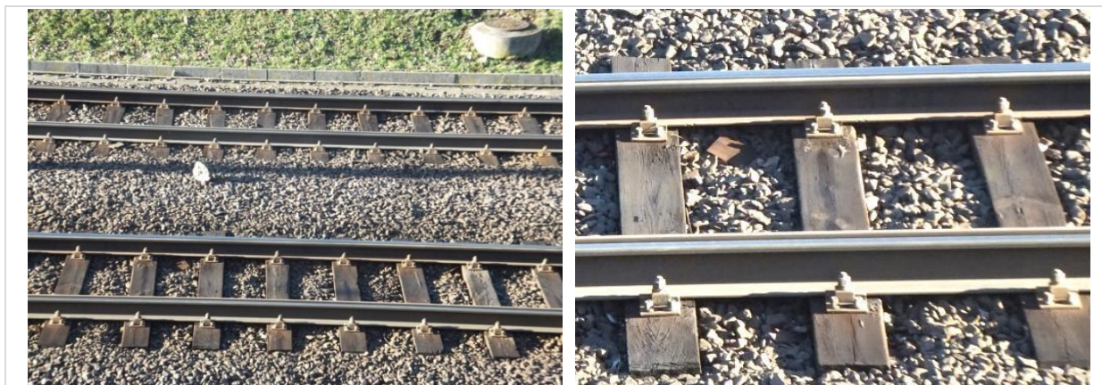
Rysunek 16 Torowisko tramwajowe o sztywnym mocowaniu szyn bezстыkowych, podkładach drewnianych i podsypce (materiały własne)
