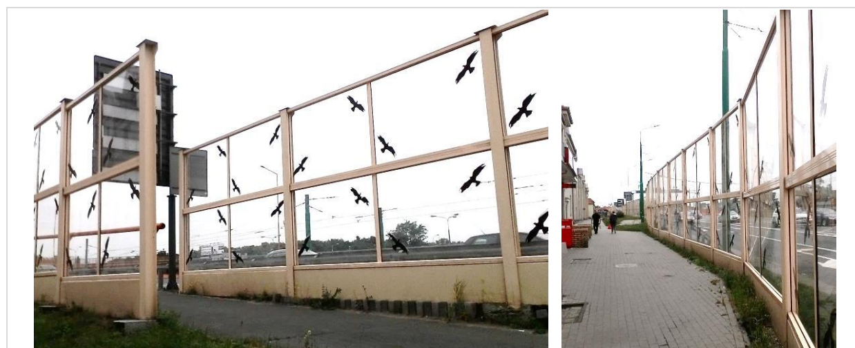
Rysunek 35 Przeierne ekrany przeciwhałasowe odbijające (na zakładkę) w pobliżu zabudowy mieszkaniowej (materiały własne)
