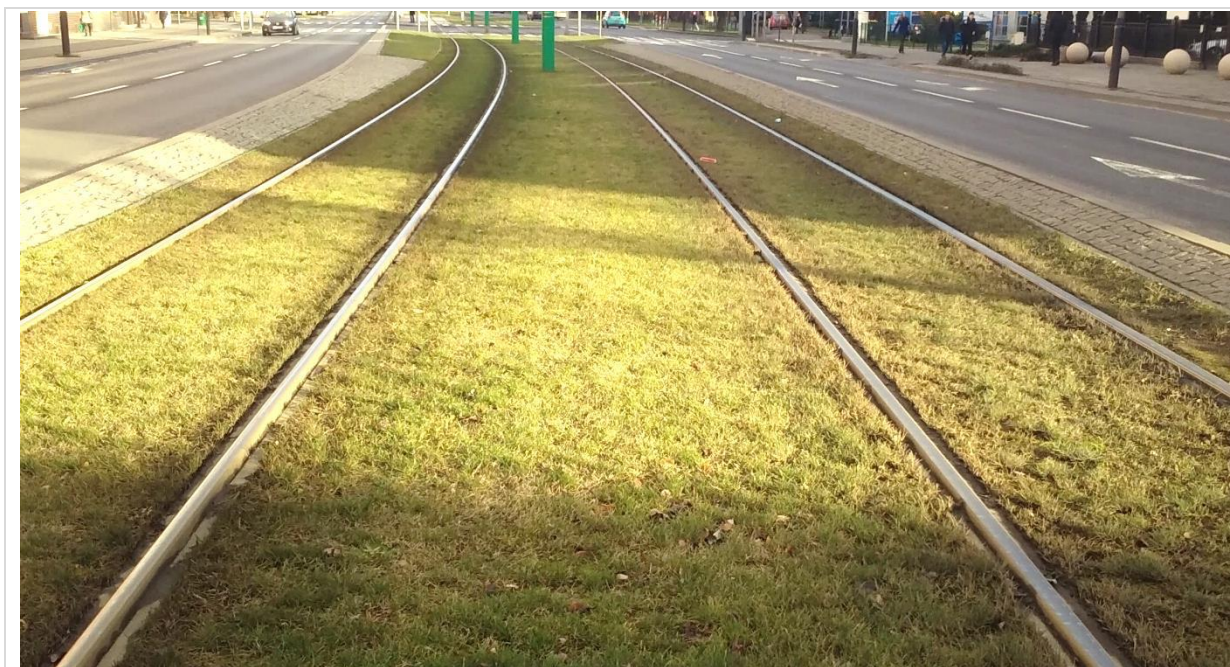
Rysunek 18 Zielone torowisko – strunobetonowe torowisko bezстыkowe z matami wibroizolacyjnymi w obrębie platform i przejazdów oraz wkładkami w komorach łukowych (materiały własne)
