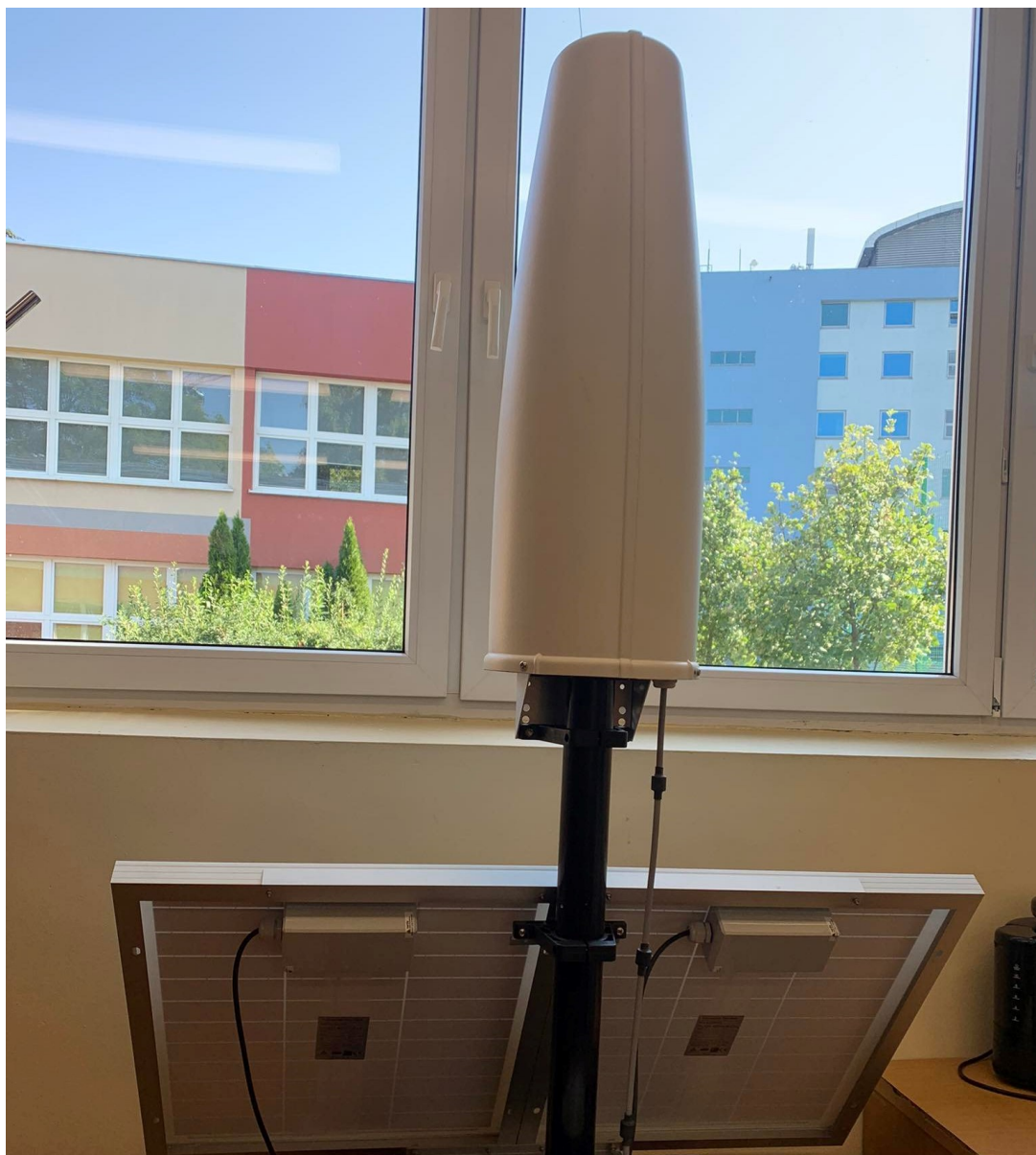
Rys. 2 Miejsce montażu SELMS PEM – dach Szkoły Podstawowej nr 97 we Wrocławiu
