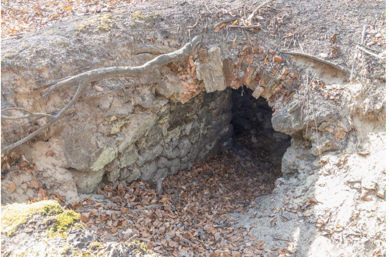
Fot. 23. Ciemne Ganki, zapadnięte sklepienie
