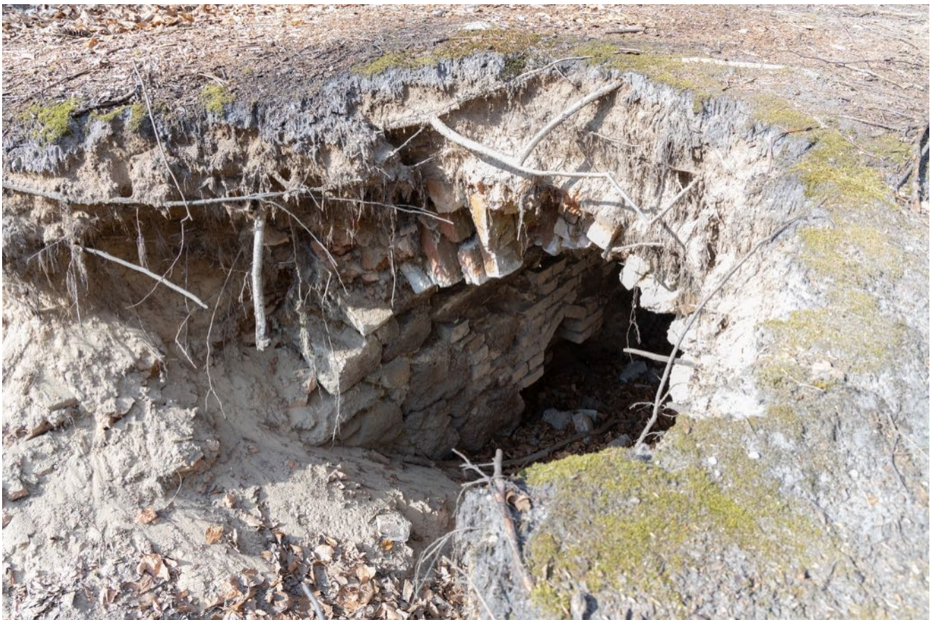
Fot. 24. Ciemne Ganki, zapadnięte sklepienie
