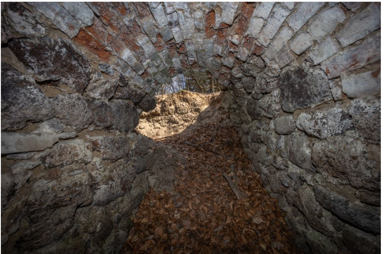
Fot. 16. Ciemne Ganki, wewnątrz z widocznym ubytkiem sklepienia
