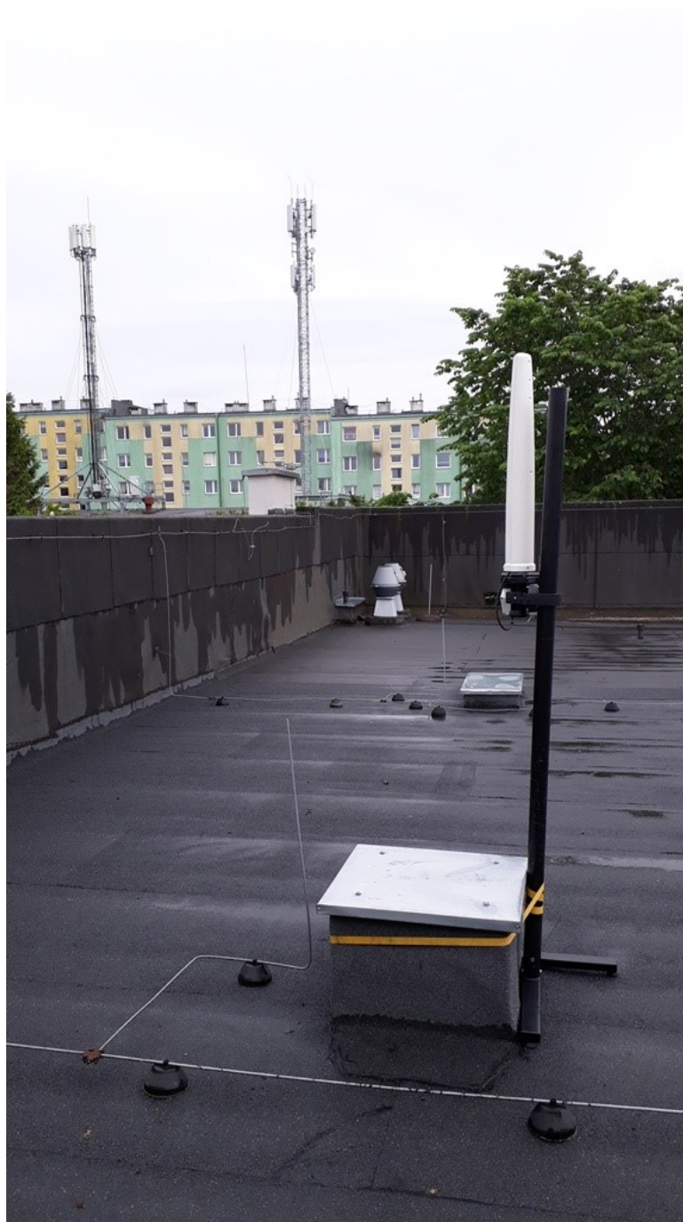
Rys. 3 Miejsce montażu SMS PEM – Szkoła Podstawowa nr 12 w Gdyni – widok na SBTK
