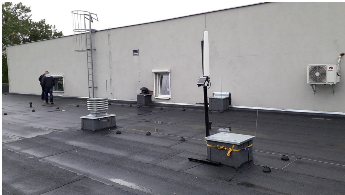
Rys. 2 Miejsce montażu SMS PEM – Szkoła Podstawowa nr 12 w Gdyni
