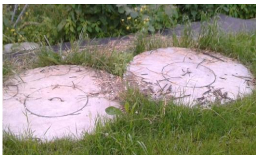
Fot. 1. Zbiorniki podziemne na wodę opadową fot. Ksymena Rosiek
