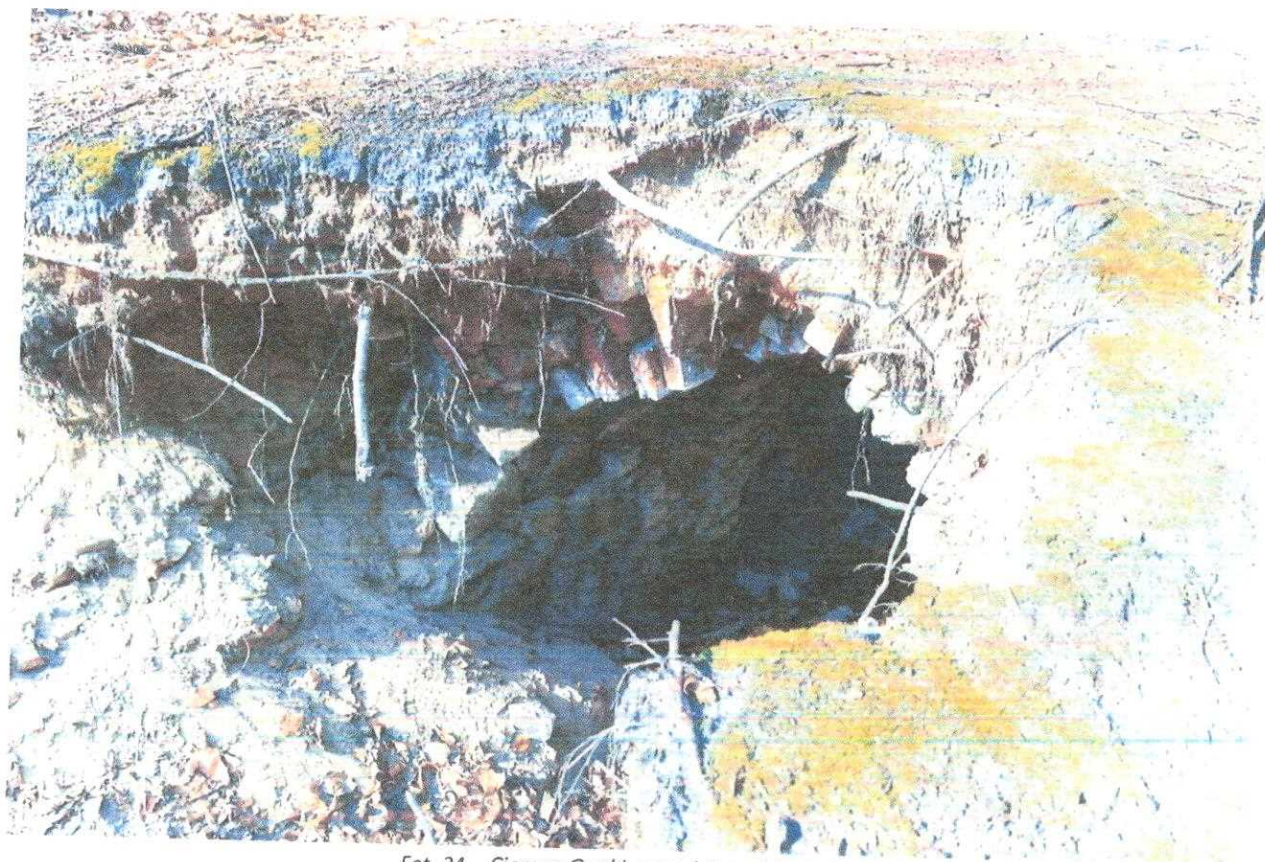
Fot. 24. Ciemne Ganki, zapadnięte sklepienie
