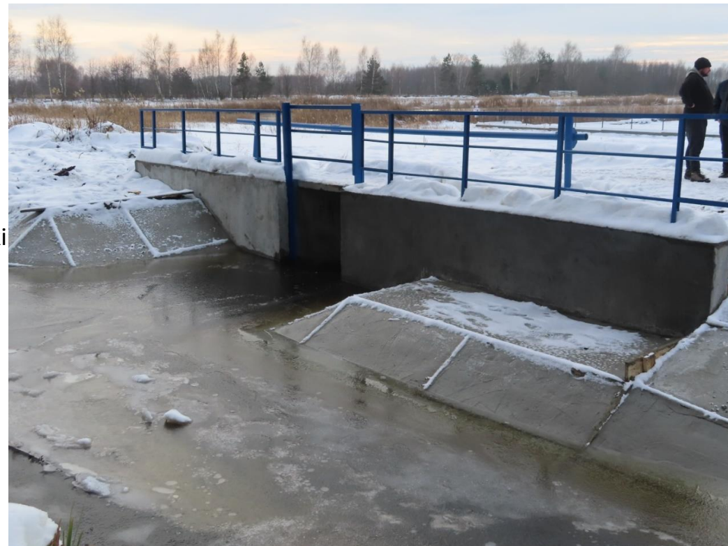
Przepusto-zastawka w km 3+484 na potoku Rzochowskim w m. Rzemień
