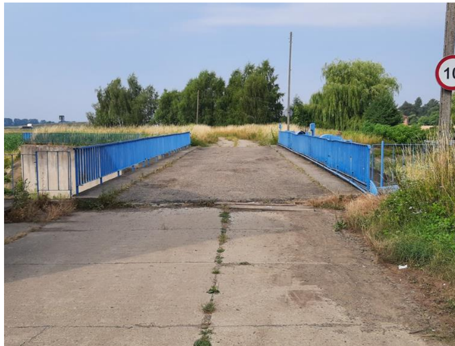
Fot. Jaz na rzece Wisznia w miejscowości Nienowice
