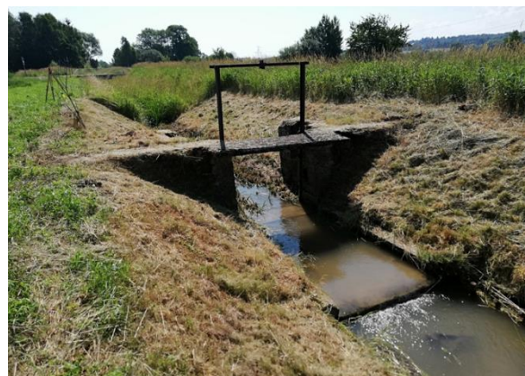
Fot. Zastawka betonowa na potoku Marcinek przed pracami remontowymi w 2021r.
