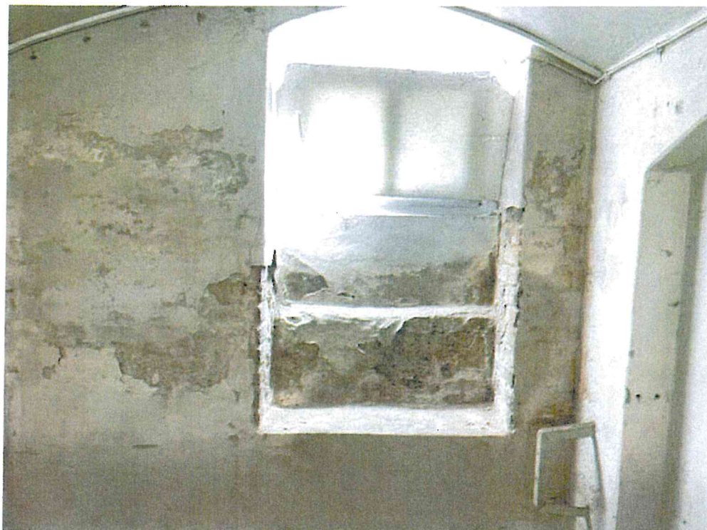
Fot. 5.6 Widoczne zawilgocenia ścian fundamentowych
